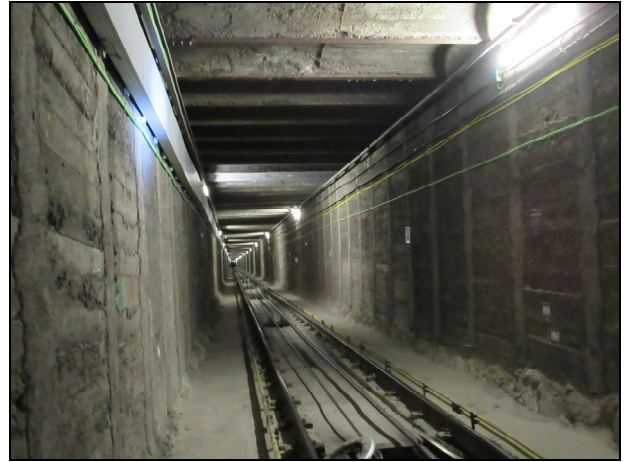
Foto 26: Oxidacions perfils nº265-264 drt.
