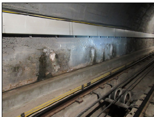
Foto 6: Detall de les filtracions al capcer.
