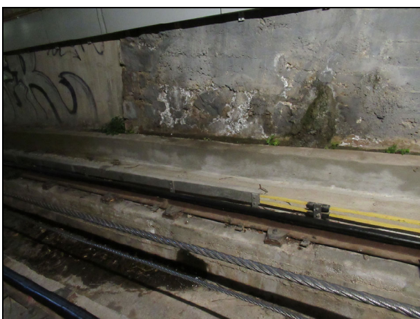
Foto 5: Detall de les filtracions al capcer.
