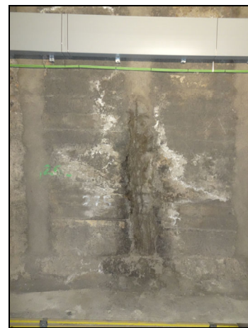
Foto 30: Filtració capcer esq. PK 000+450.
