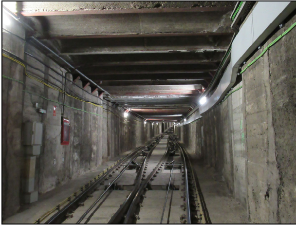
Foto 25: Oxidacions perfils nº265-264 esq.
