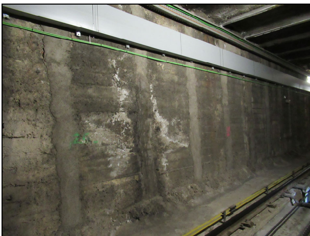
Foto 29: Filtració capcer esq. PK 000+450.
