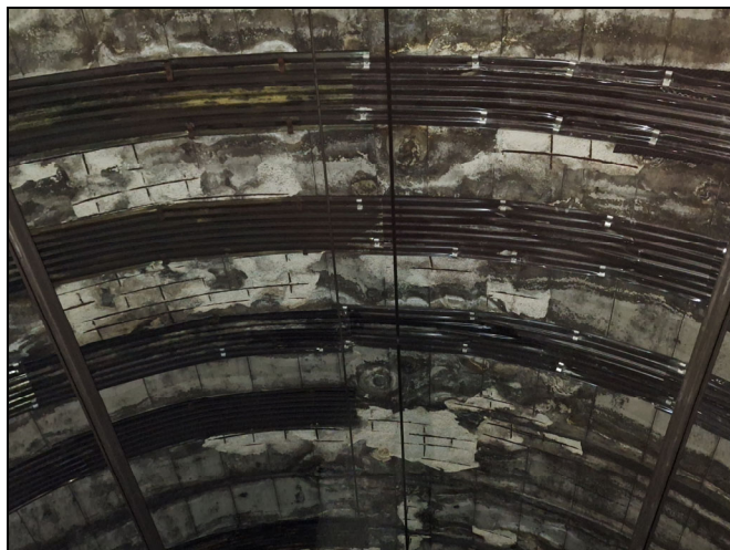
Foto 12: Detall d'armadures vistes a la volta.
