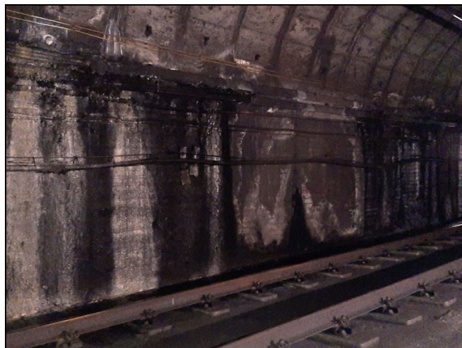
Foto 8: Filtració junta capcer – volta.
