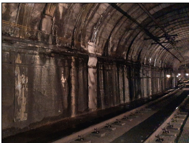
Foto 3: Filtracions volta i capcer
