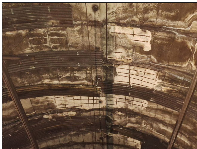
Foto 10: Detall d'armadures vistes a la volta.
