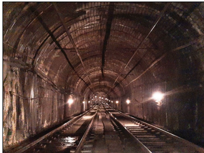
Foto 2: Vista de la secció afectada.
