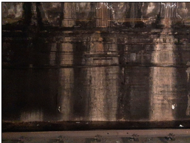
Foto 7: Filtració junta capcer – volta.
