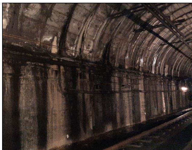
Foto 4: Filtracions volta i capcer
