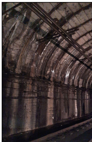
Foto 5: Filtracions volta i capcer
