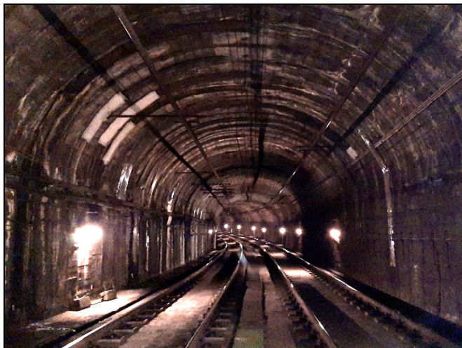
Foto 1: Vista de la secció afectada.
