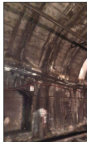
Foto 6: Filtracions volta i capcer.
