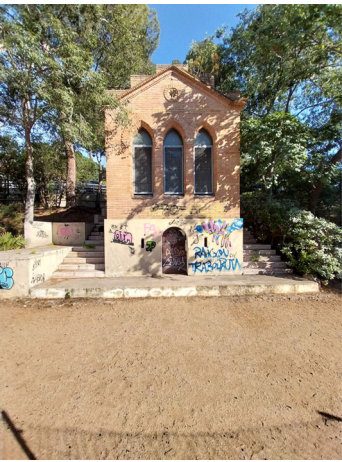
Foto S1-F5 Caseta de maó vandalitzada i urbanització de travertí executada a inici dels anys 2000, d'alt impacte paisatgístic.
