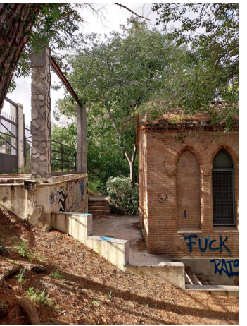
Foto S1-F9 Accés inoperatiu vinculat a la urbanització de la caseta de maó
