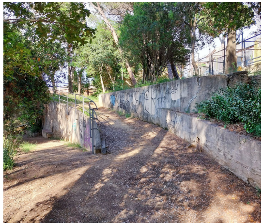
Foto S1-F2 Murs de contenció que conformen els camins, vandalitzats amb pintades i amb presència de lesions per les empentes de les arrels
