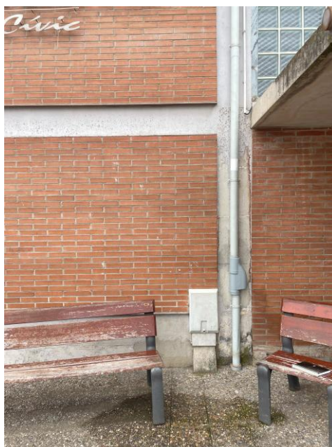
Figura 12. Punt de connexió existent al Centre Cívic Cooperativa Sarrià de Ter. Font: elaboració pròpia.
