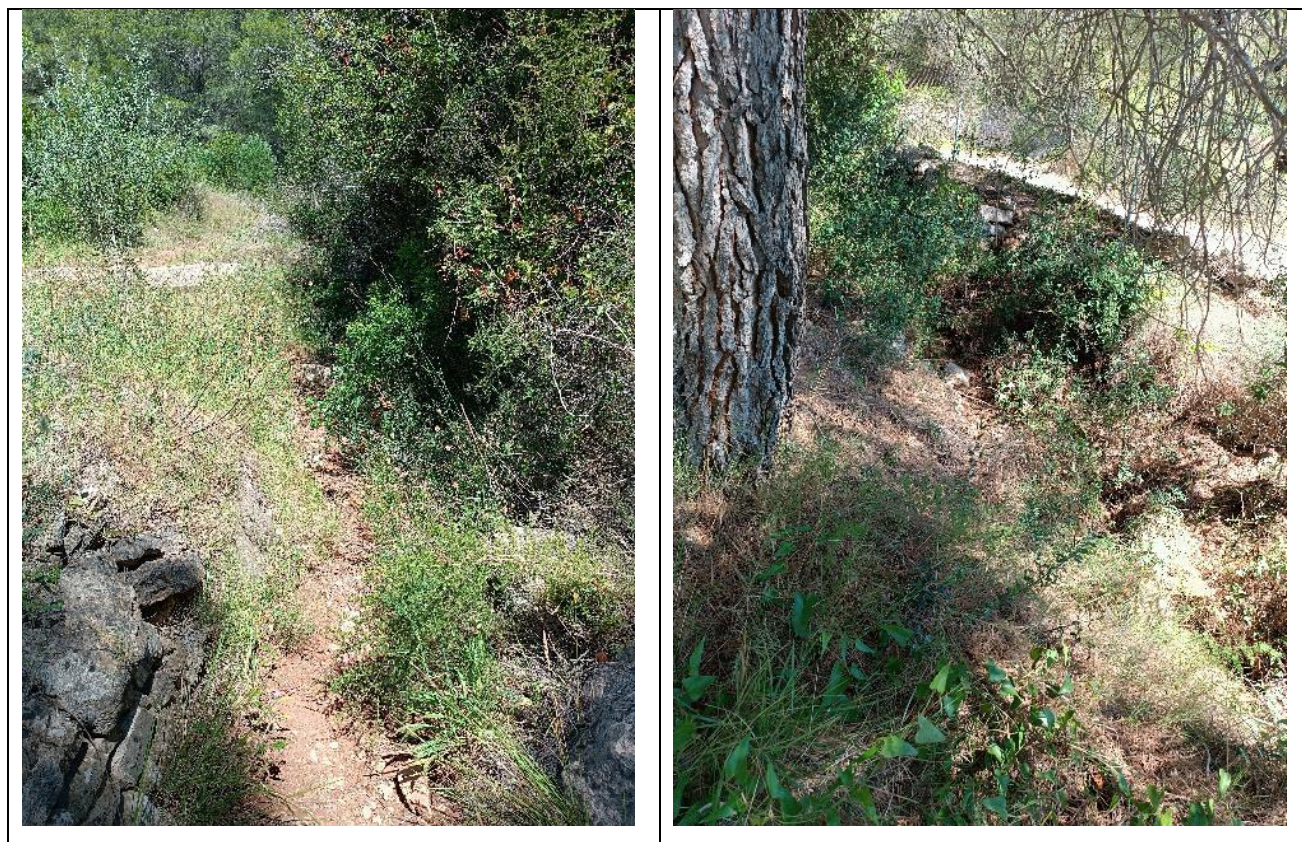
Figura 36 Imatges del tram de la sèquia que és el sender d'entrada dels Solans, amb la vegetació cobrint la plataforma i les pedres enmig del pas.
