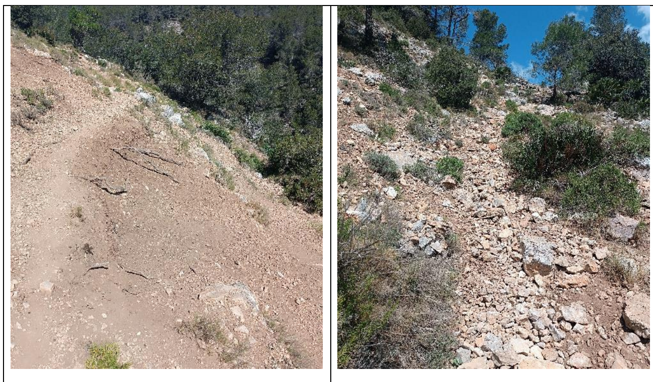
Figura 28 Imatges tram Bc. Melica, sector erosionat pas bestiar on es fa nou marge de pedra en sec, i dreceres de les motocicletes, obertura plataforma per anar a nivell.
