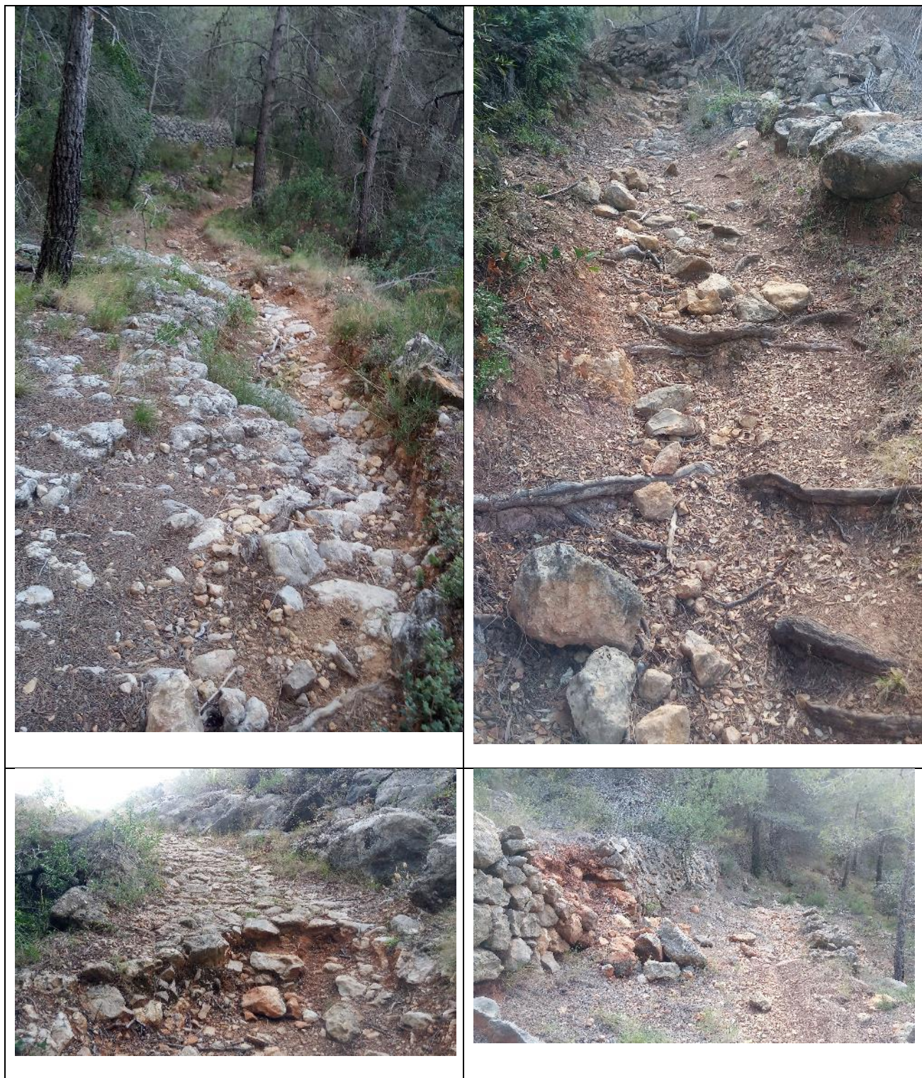
Figura 20 Imatges, sector erosionat pas motoritzat, amb la degradació d'empedrats i esllavissades dels marges superiors de la plataforma.
