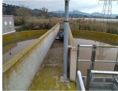
Vista superior d'espessidor
