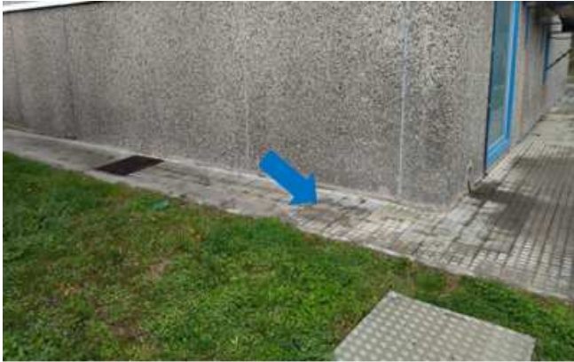
Sortida tub aire soterrat al exterior de sala centrifugues
