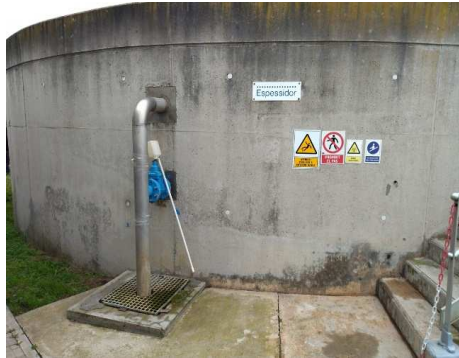
Vista general espessidor
