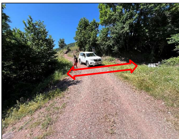
Foto 18: Creuament de la pista amb el torrent a on no existeix una obra de drenatge transversal (Font: Montserrat Solanelles Ubach).
