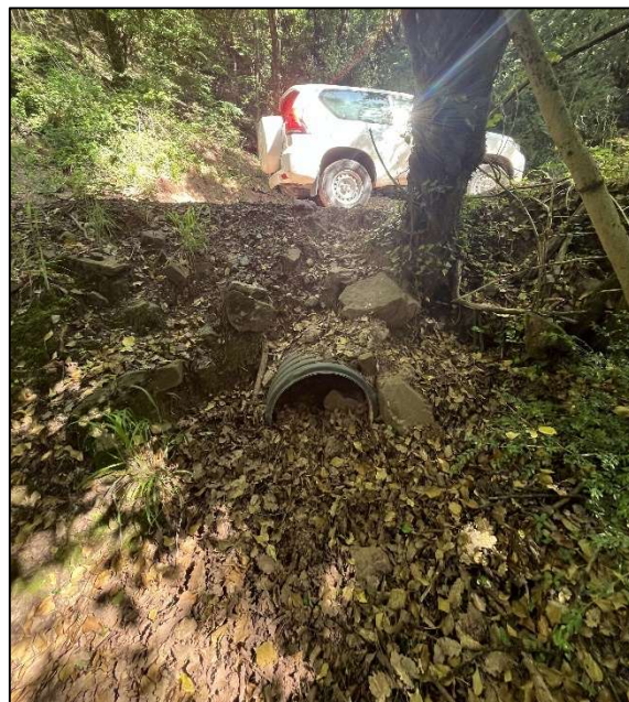
Foto 4: Taponament amb terra, fulles i branques a la sortida del tub de drenatge existent (Font: Montserrat Solanelles Ubach).
