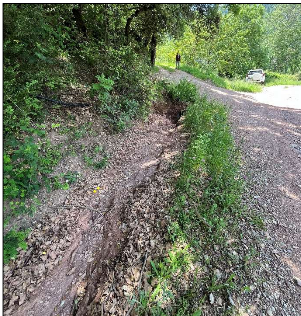
Foto 3: Tram amb cuneta i tub a l'entrada d'un camí, amb sediments a l'entrada del tub (Font: Montserrat Solanelles Ubach).
