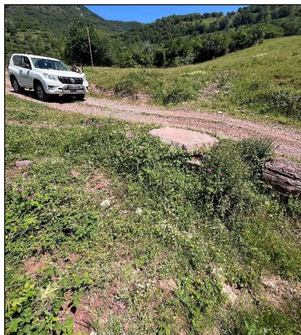
Foto 10: Obra de drenatge amb l'arqueta d'entrada i de sortida totalment aterrada de sediments (Font: Montserrat Solanelles Ubach).
