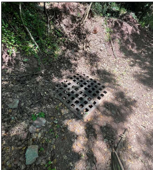
Foto 11: Obra de drenatge amb l'arqueta d'entrada plena de sediments (Font: Montserrat Solanelles Ubach).
