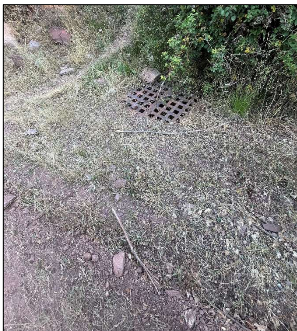
Foto 9: Obra de drenatge amb l'entrada plena de sediments i vegetació obstruint l'entrada d'aigua (Font: Montserrat Solanelles Ubach).
