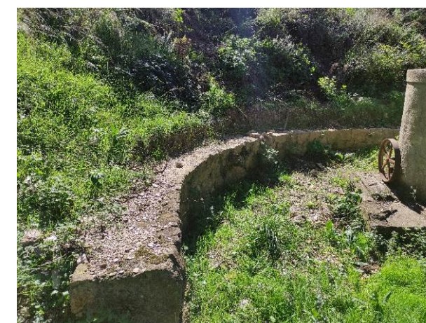
Banc amb talús en mal estat al darrera
