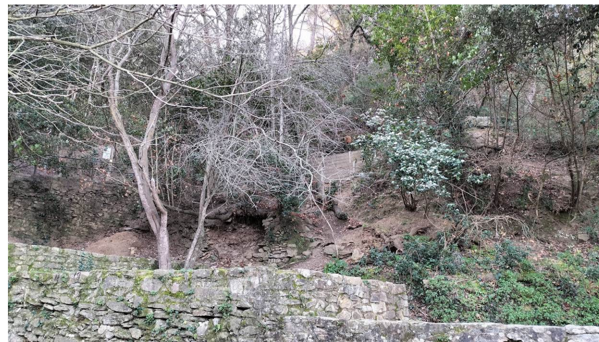
Zona erosionada i estructures de contenció actuals
