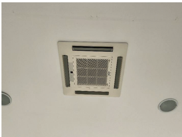
Split aire condicionat sala principal
