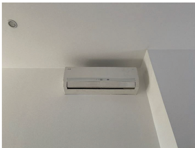
Split aire condicionat sala rebedor
