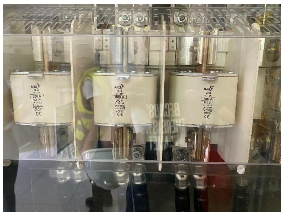
Trafo i fusibles
