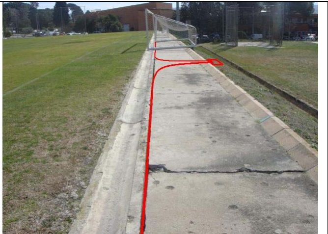
Situació del cinquè armari 08205RK01LC4051. En aquest lateral del camp la canalització passa al costat interior de la vorera
