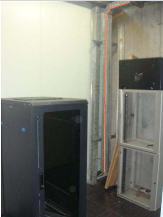
Vista 10_Canaletes d'accés al terra tècnic del CPD
