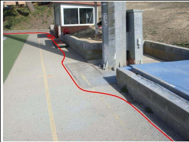
Pericó 08205PE0980 davant la caseta de la pista d'atletisme i canalització en micro-rasa seguint el perímetre exterior de la instal·lació
