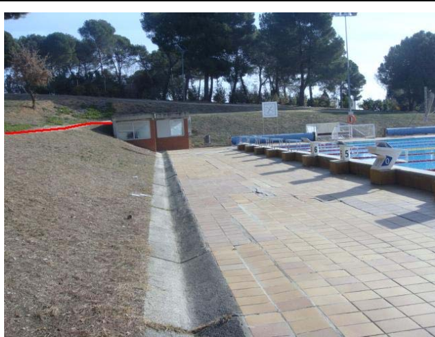
Caseta de la piscina exterior i canalització per terreny natural fins a la part posterior de la caseta
