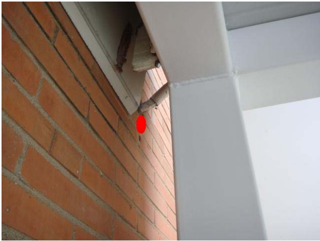
Vista 5_Detall del passamurs de sortida de l'habitació 300 a la passera elevada
