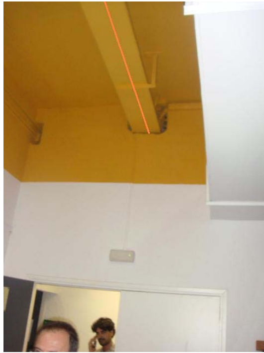
Vista 5_Entrada del cable al gimnàs groc per canaleta existent
