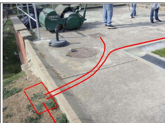
Ubicació del sisè armari 08205RK01LC4052 amb la canalització que arriba des de l'armari 08205RK01LC4051, la connexió a l'arqueta elèctrica i les canalització que tanca l'anell cap al primer armari
