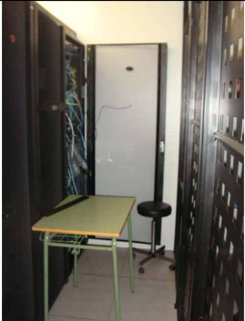
Vista 11_Armari rack 08205RK02LC4056 del CPD on acabar el cable de 48FO
