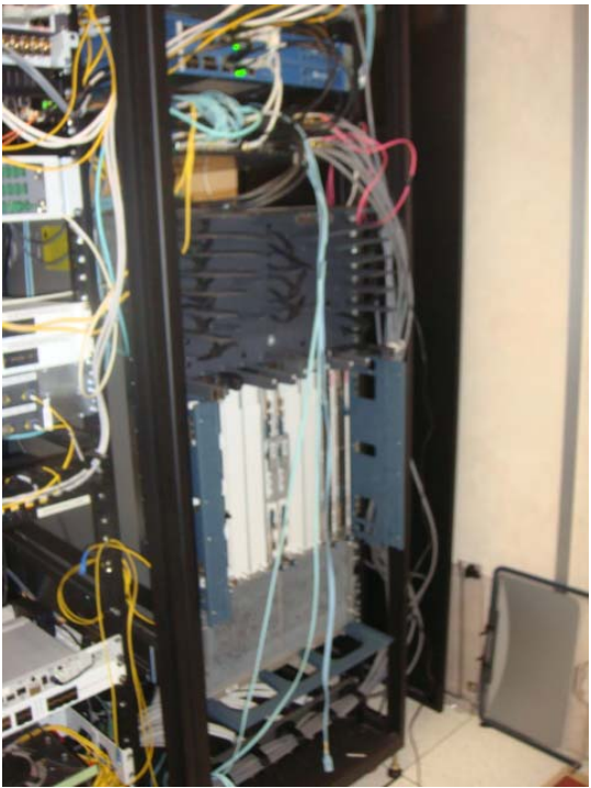
Armari rack 08205RK02LC4001 de la sala NCC des d'on sortirà el cable de 144 FO
