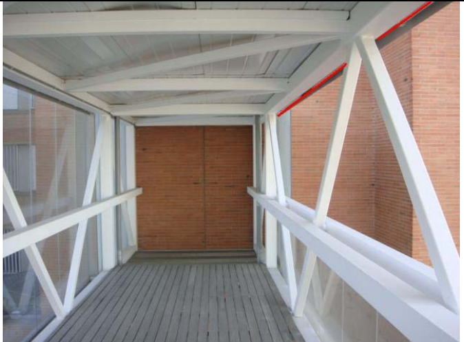
Vista 5_Tub metàl·lic fixat a l'estructura de la passera elevada
