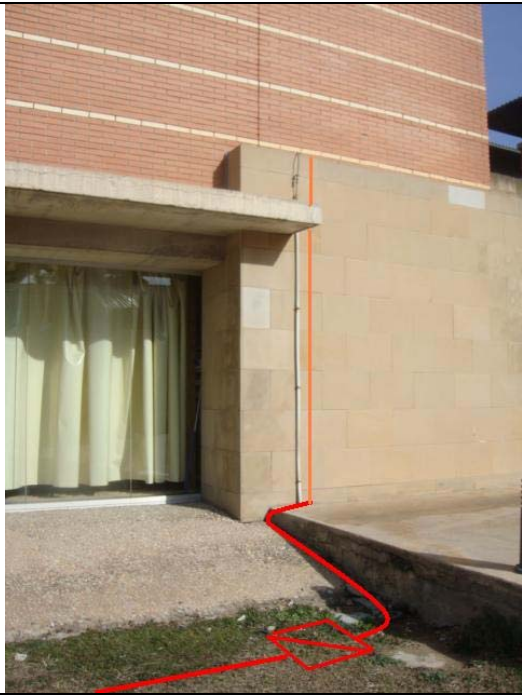
Vista 2_Estesa fins al pericó 08205PE0978 i sortida lateral per tub metàl·lic a la façana de l'edifici de rítmica
