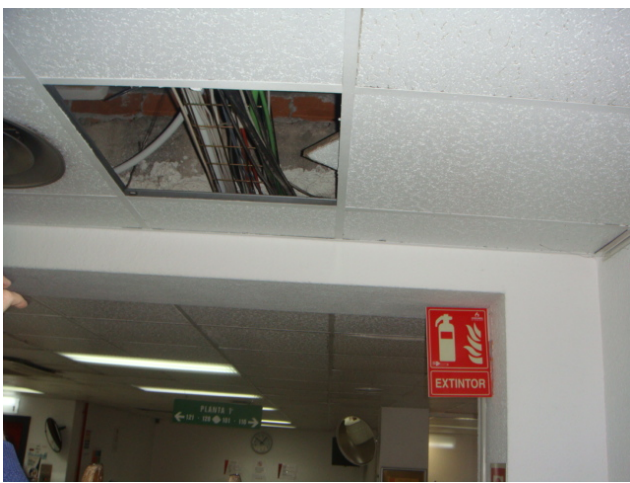
Canaleta al fals sostre de l'edifici de la Residència
