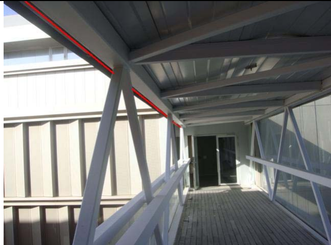
Tub metàl·lic a la passera fins a l'edifici del CPD
