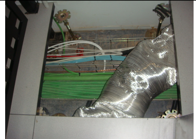
Terra tècnic a la sala del CPD
