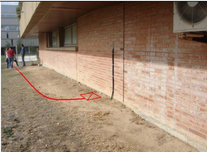
Pericó 08205PE0982 de finalització de la canalització elèctrica al costat de l'edifici
