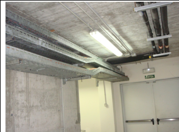
Canaletes a la planta soterrani fins al CPD
