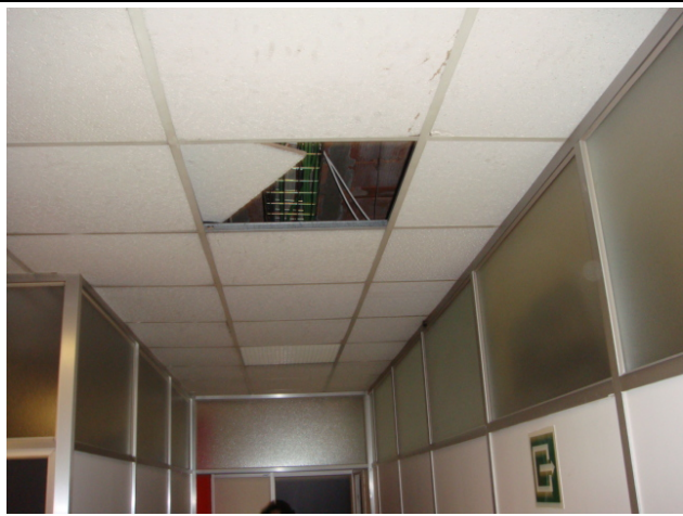
Vista 1_Sortida del NCC per safata al fals sostre del passadís
