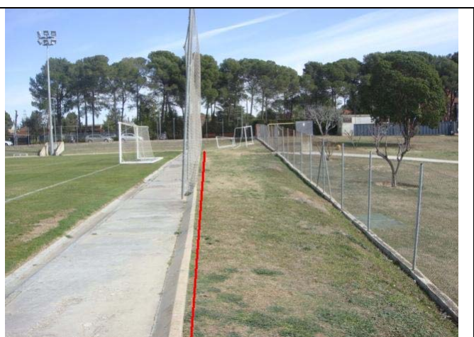
Canalització per terreny natural entre els armaris 08205RK01LC4052 i 08205RK01LC4047
