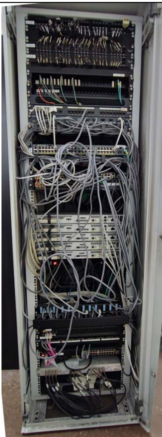
Vista 2_Armari rack de la Residència
