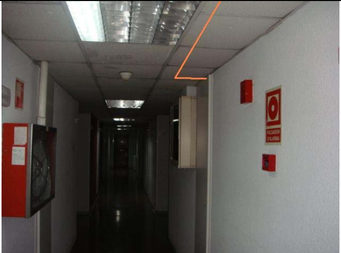
Vista 2 en planta 3ª_Sortida del muntant a la 3ª planta per la canaleta del fals sostre cap a l'habitació nº 300
