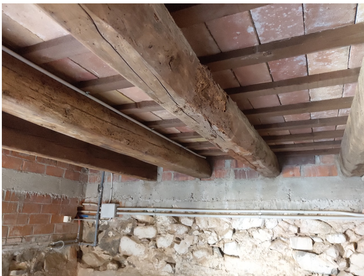
Estat d'alguna de les bigues de les cambres de la planta baixa de l'annex nord
