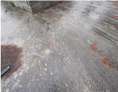
Fissures a l'exterior de la capa de compressió de la coberta.
