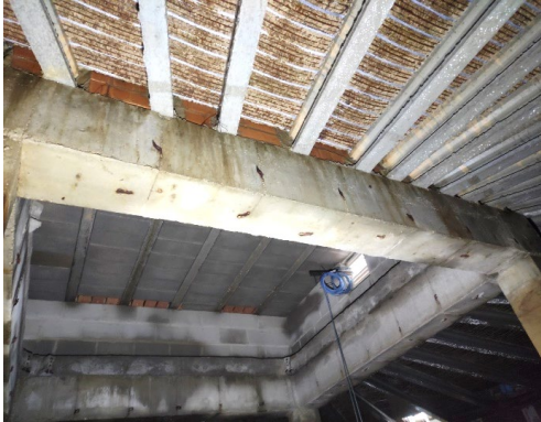
Detall dels punts d'oxidació a les jàsseres.
