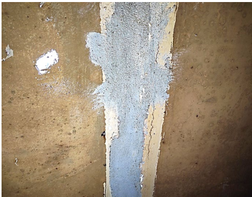
Estat actual del segellat interior, executat en reparacions de manteniment anteriors.
