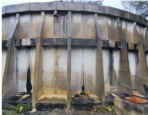
Fuites d'aigua a través de les juntes exteriors de les peces prefabricades.
