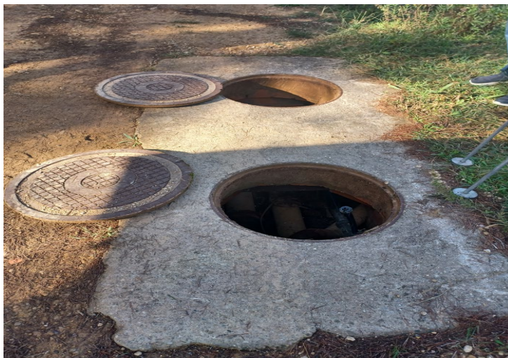
Imatge 2.- Arqueta on cal fer el bypass.
