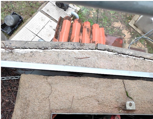
Fissures al coronament perimetral de la coberta.
