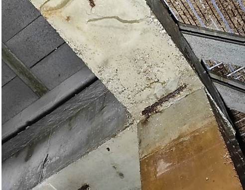
Detall dels punts d'oxidació a les jàsseres.
