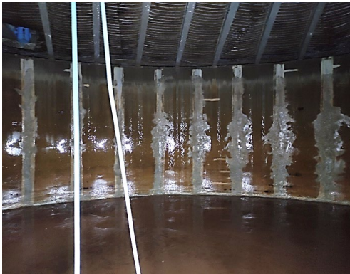
Fuites d'aigua a través de les juntes interiors de les peces prefabricades.
