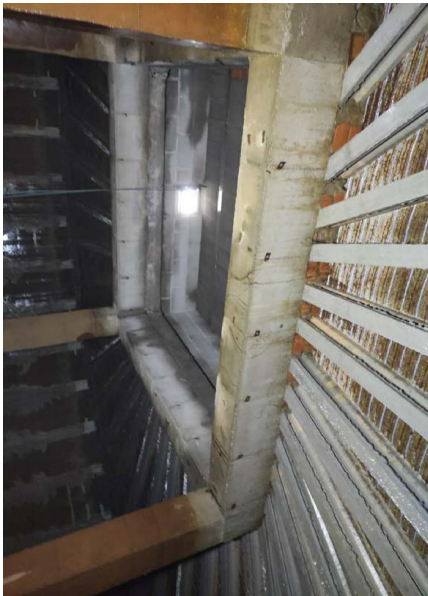
JÀSSERES - PUNTS AMB OXIDACIÓ D'ARMAT A LA VISTA
