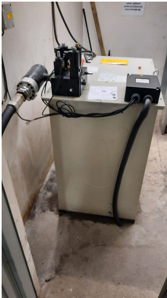
Detall del grup hidràulic substituït.
