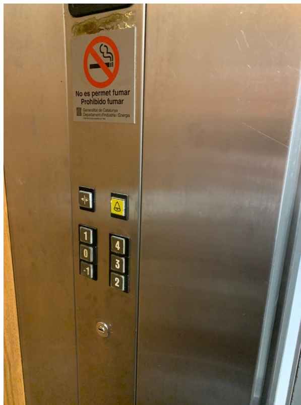
Detall de la botonera interior de cabina.
