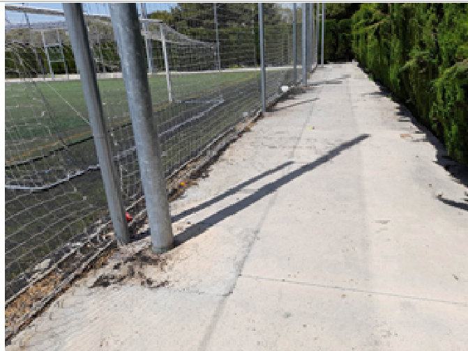
Detall de barana perimetral amb punts d'òxid
