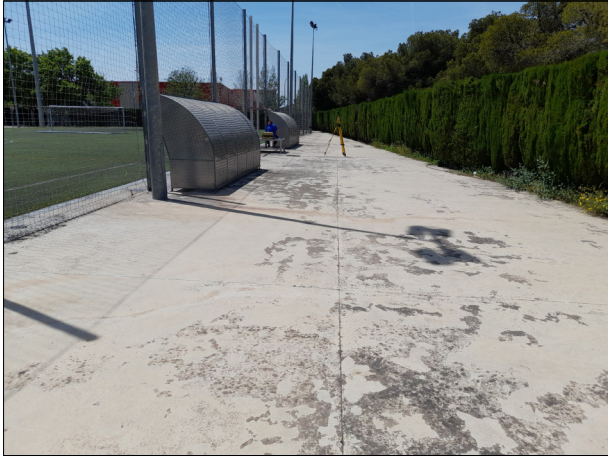
15. DETALL DE L'ESTAT DEL PAVIMENT DE FORMIGÓ
