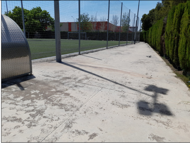
17. VISTA DE L'ESTAT DEL PAVIMENT DE FORMIGÓ BANDA NORD DEL CAMP
