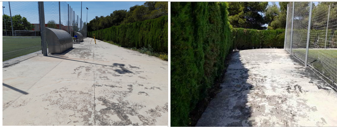
Detall de l'estat de cristallització a causa de les sals en el paviment de formigó armat perimetral del camp de futbol F-7
