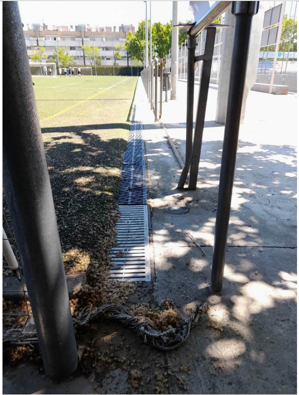
Detall de l'estat de la barana perimetral en l'accés de vehicles
