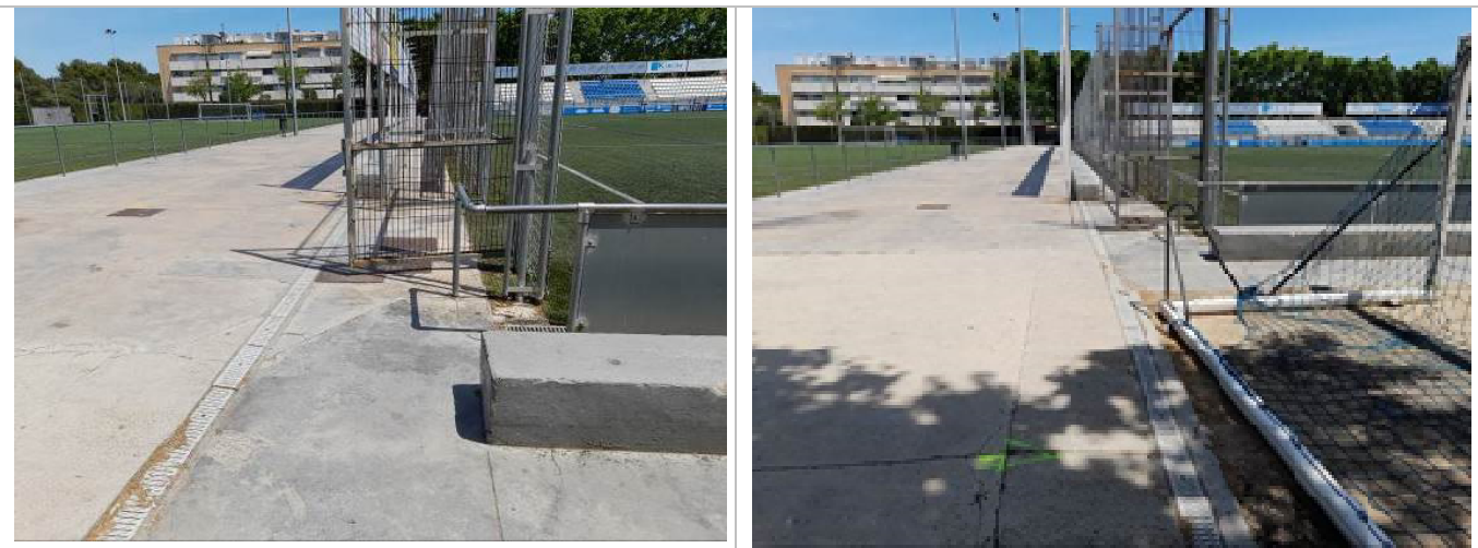
Detall de l'estat del carril central de paviment de formigó armat i que separa el camp de futbol F-11 del F-7
