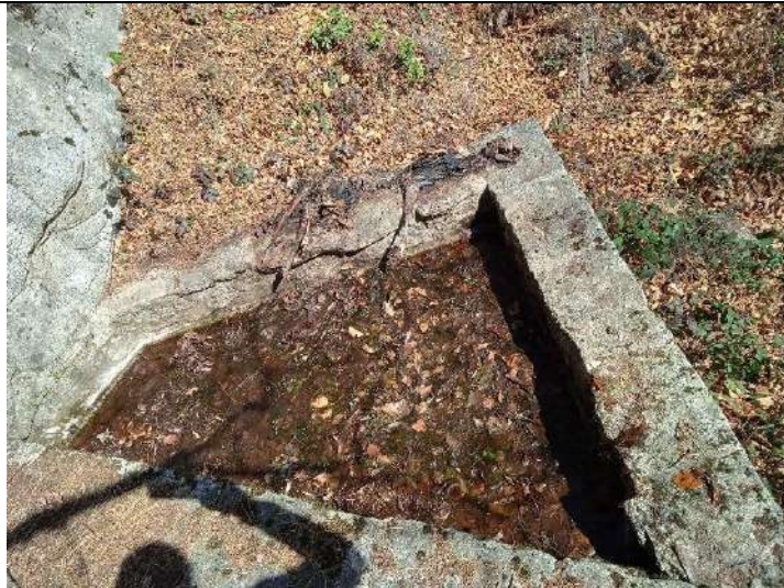
Basseta petita annexa a bassa gran. Previsió de neteja, repicat i impermeabilització.
