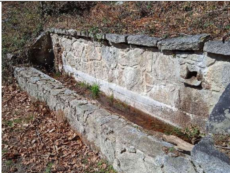
Abeurador. Actuació prevista neteja, reparació i refer lliscat interior de ciment
