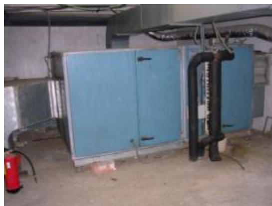
020 Evaporador amb bateria calor Magatzem Fonoteca
