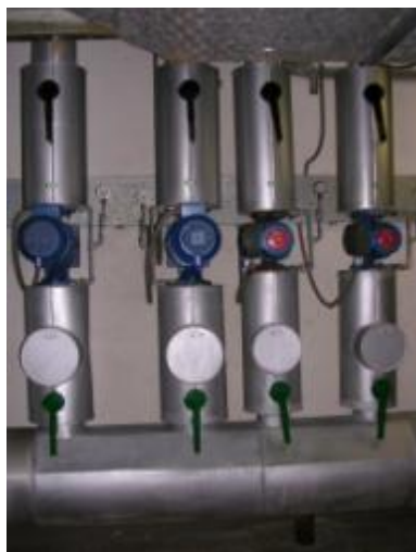
037 Bombes recirculació oficines i S. Lect.
