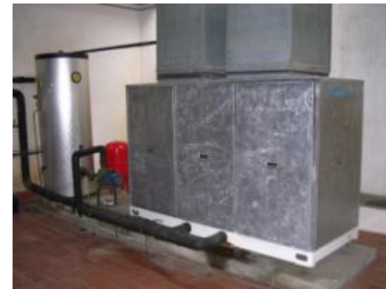
021 Bomba de calor magatzem fonoteca
