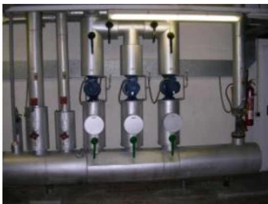
038 Bombes recirculació Bombes Calor n°1 i n°2
