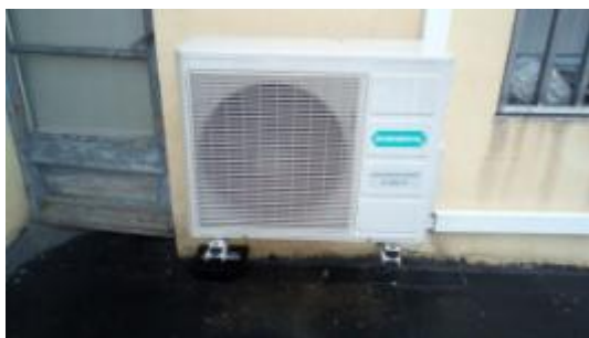
V020 Condensadora P2 Sala Gran Restauració
