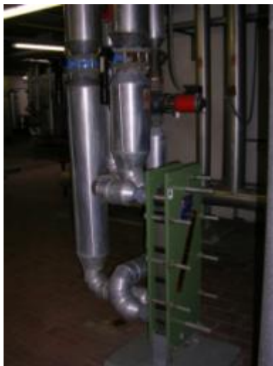
035 Intercanviador plaques i vàlvula 3 vies
