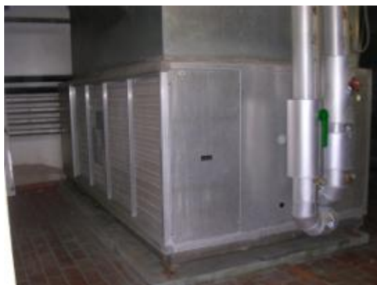
025 Bomba de Calor n° 2 Oficines i Sales Lectura
