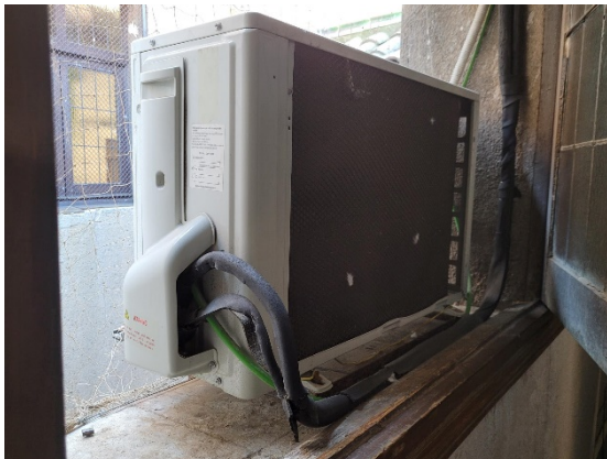
115 Condensadora Accés Mag. Compactus Música
