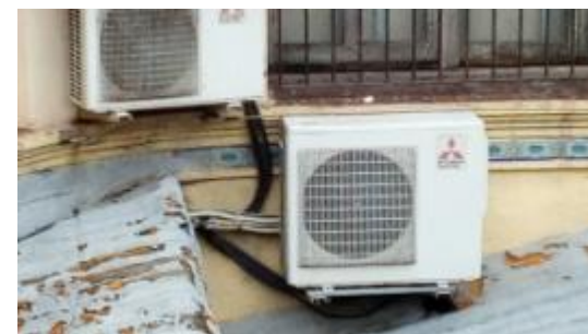
V006 Condensadora PB Dipòsit Legal
