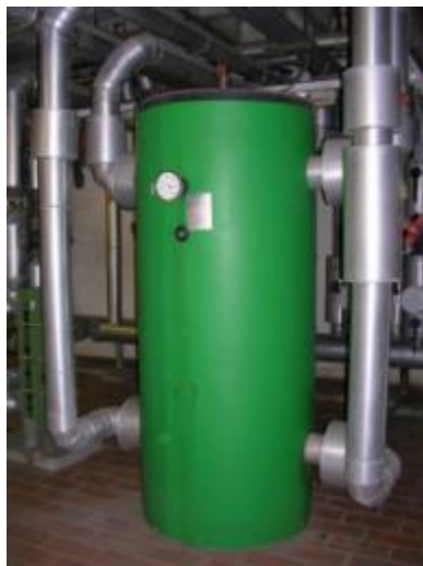
034 Dipòsit mescla aigua freda dipòsits
