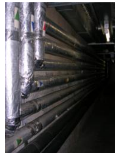
045 Exemple conductes aïllats
