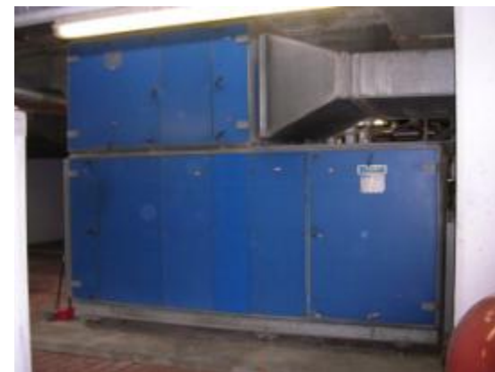
027 Climatitzador amb recuperador entàlpic CL2
