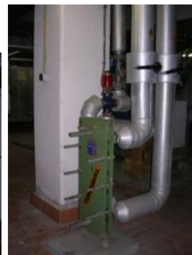
039 Bescanviador plaques Bombes Calor
