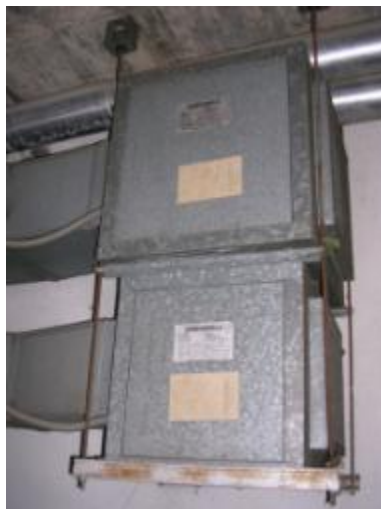
028 Ventilador sobrepressió escales
