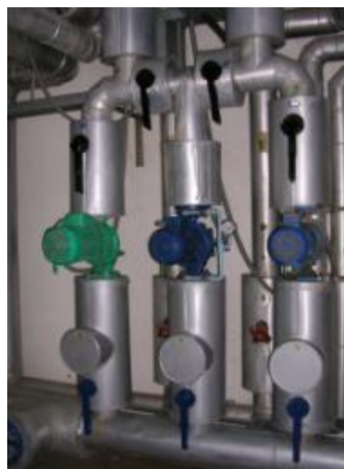
032 Bombes recirculació B1.1, B1.2 i B1.3
