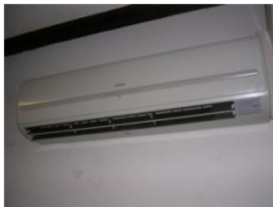
121 Sala Servidors ATI costat esquerre
