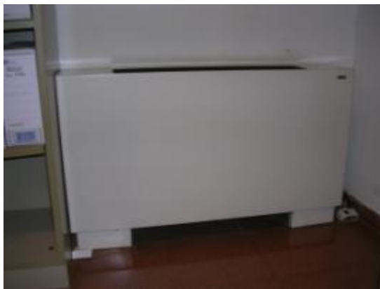
047 Fan-coils edifici oficines
