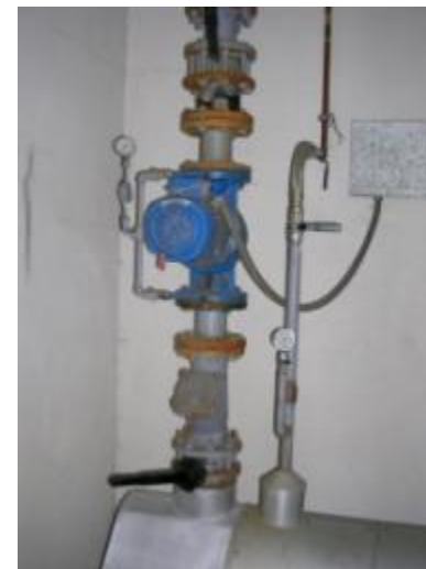
036 Bomba intercanviador i ompliment Bombes calor
