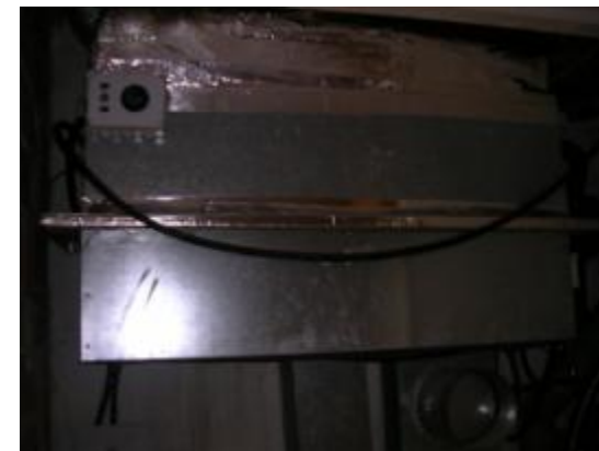
048 Fan-coils zones treball edifici oficines
