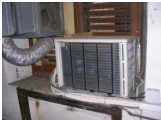
019 Condensadora fotos 017 i 018
