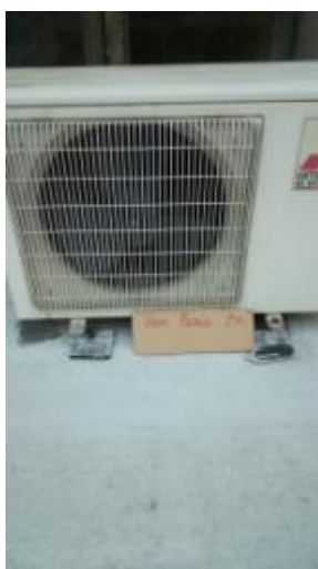
V029 P1 Condensadora Despatx Hemeroteca
