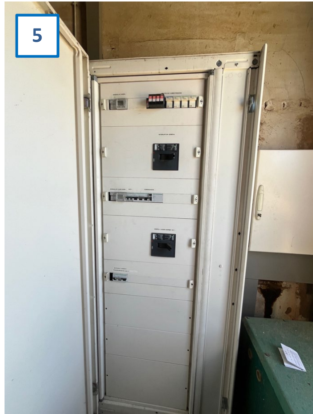
Imatge 5. Ubicació quadre general existent sala bombes a on es connecta la instal·lació fotovoltaica
