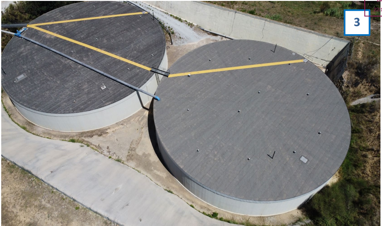
Imatge 3. Vista general de la instal·lació fotovoltaica cobertes dipòsits
