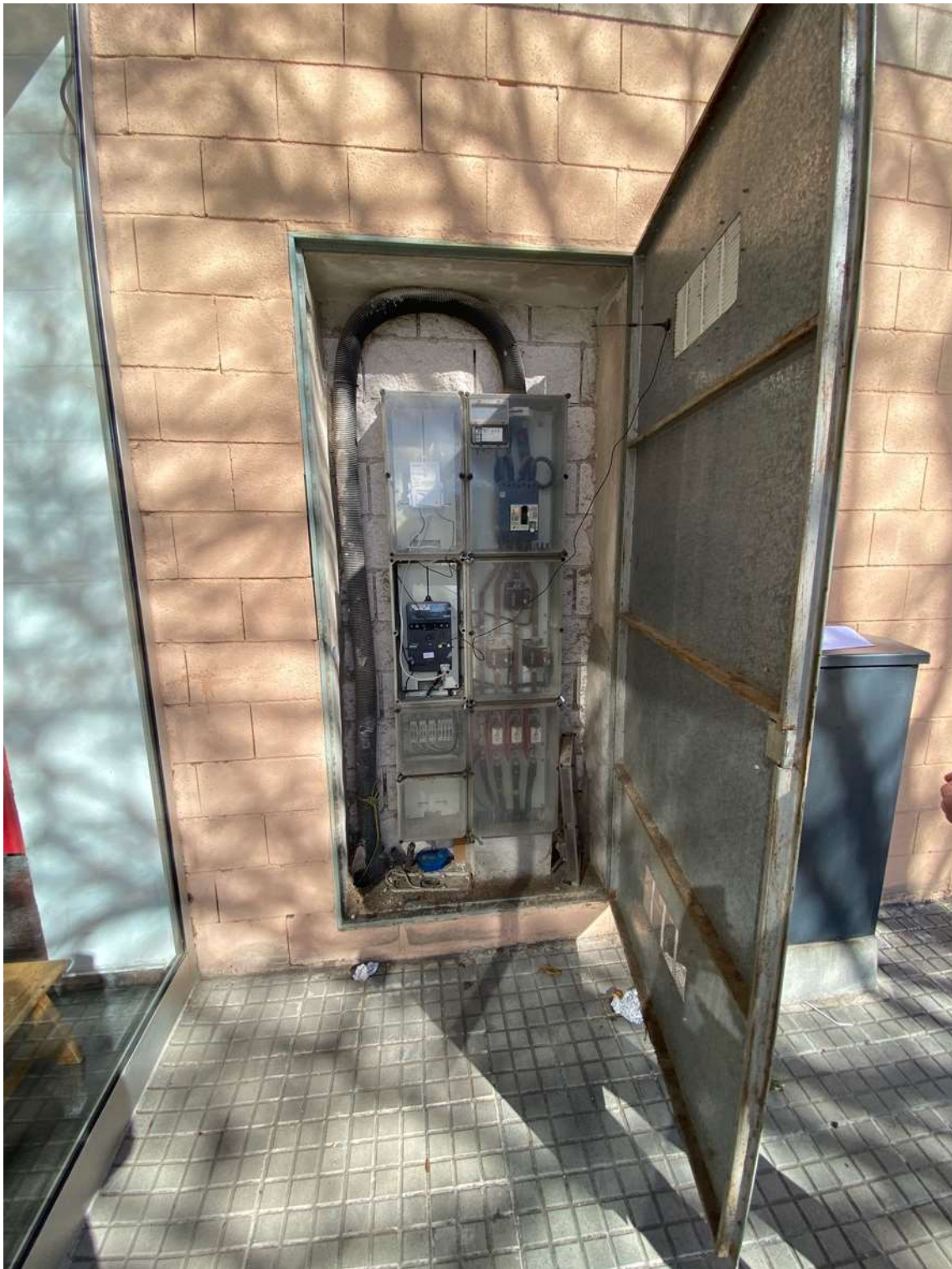
Imatge 3. TMF10 de l'edifici i armari amb CS+CGP
