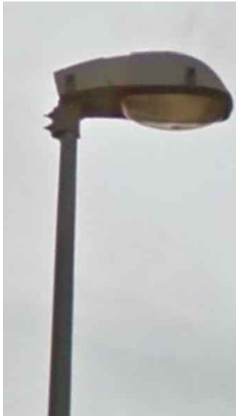
● Llumenera de suport vertical existent
