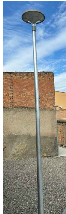
● Llumenera tipus downlight LED existent
