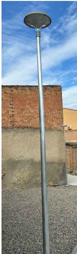
● Llumenera tipus downlight LED existent
