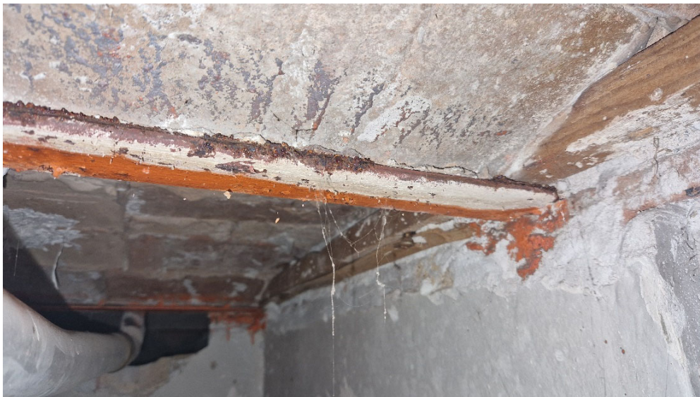
3-1. Vista de bigueta en cambra humida i paret del pati
