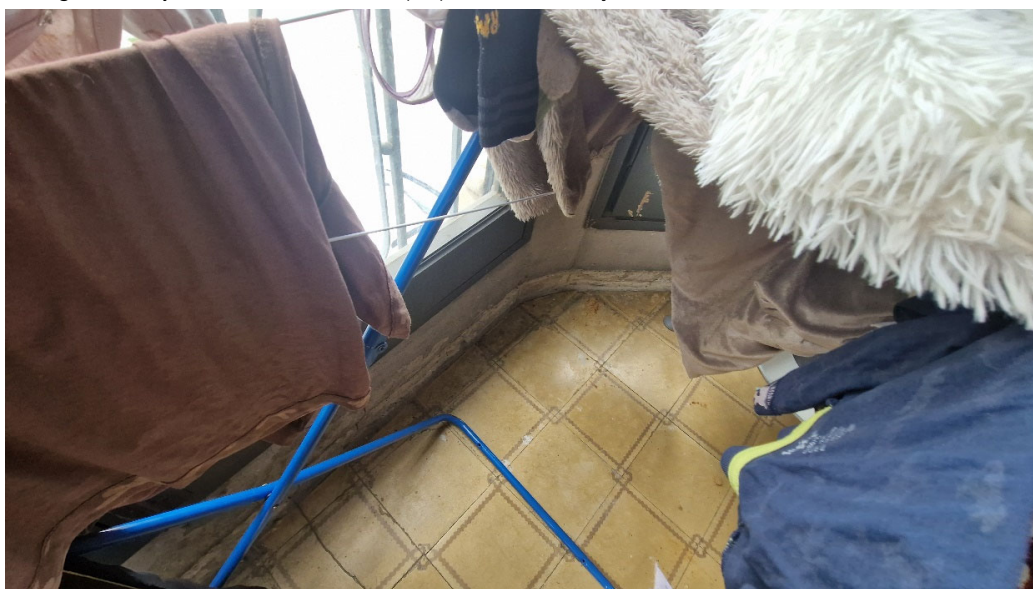
1-1 Vista general galeria amb filtracions d'aigua
