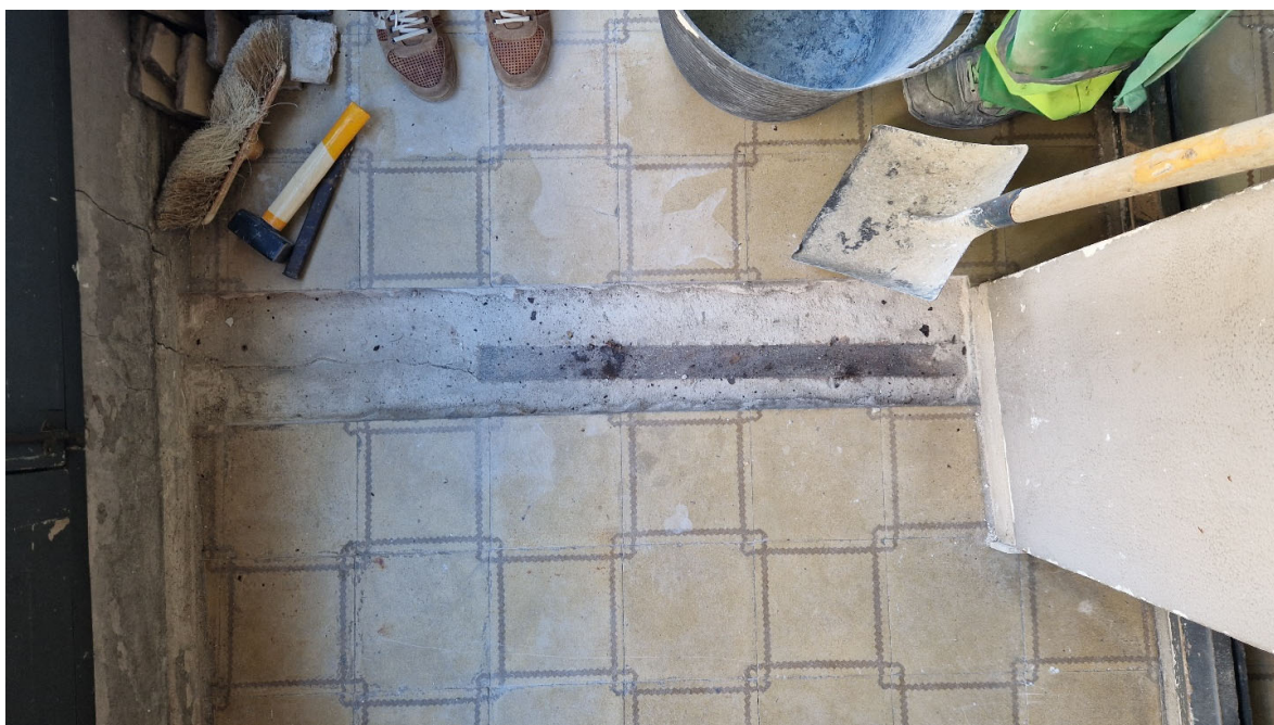
Paviment dela tribuna del 1-1, on es veu que la bigueta del balcó original és més curta que el vol actual
