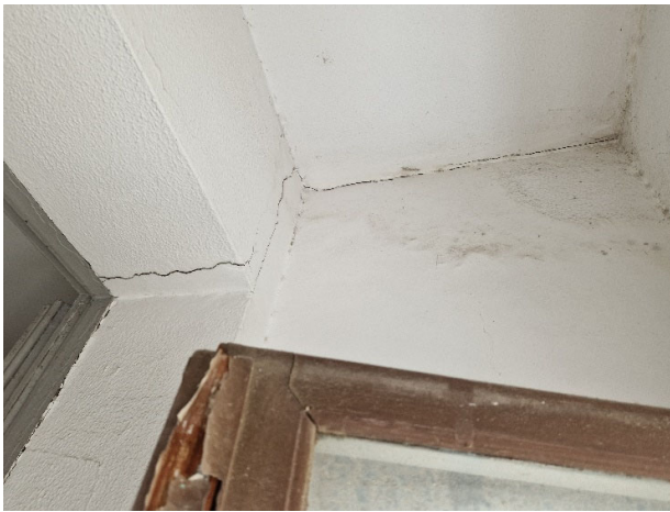
3-1-Esquerda dintell i sostre galeria
