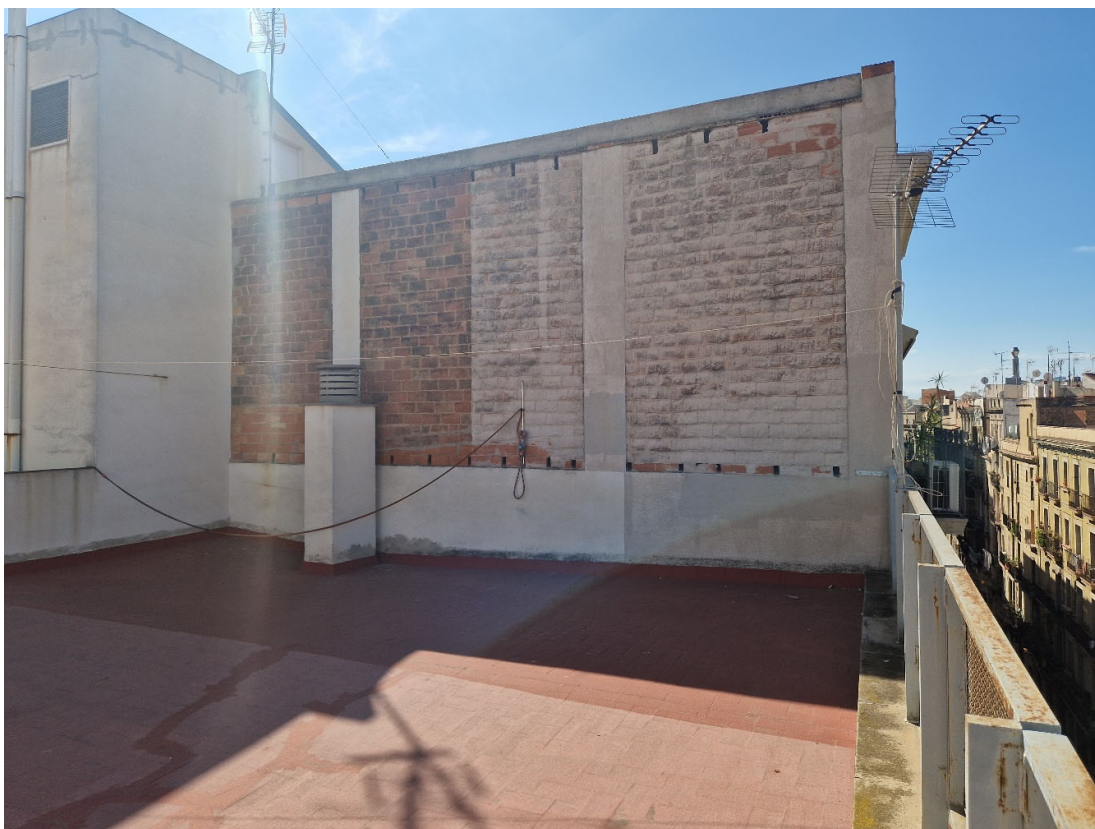
Paret mitgera vista des de la coberta de C/ del Comerç 52
