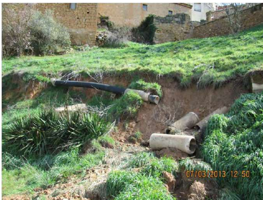
Imatge del tram de canonada ensorrat després d'una primera reparació d'urgència
