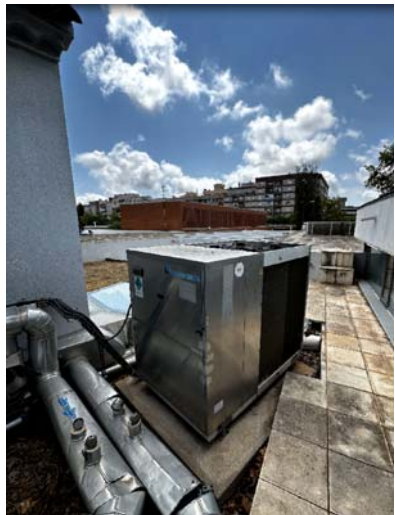
Unitat Exterior Clima Existent a Substituir
