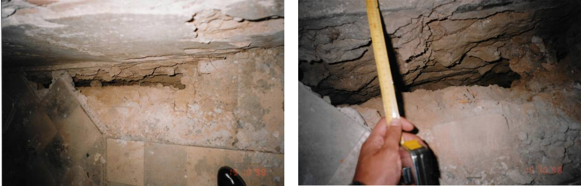
Separació del mur de contenció de la planta semisoterrani respecte del paviment de planta baixa
