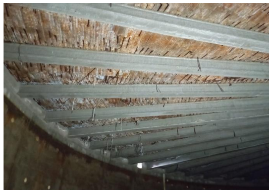
Fotografia 9. Interior del dipòsit, presència d'òxid en la coberta (Agbar)
