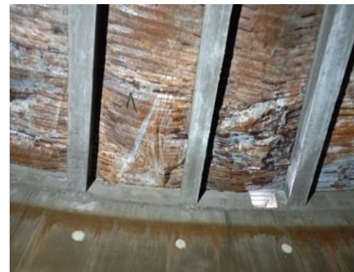
Fotografia 10. Interior del dipòsit, presència d'òxid en la coberta (Agbar)
