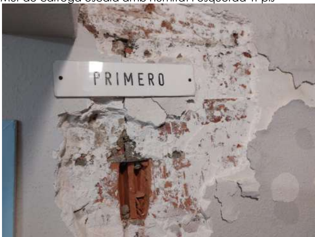
Cala realitzada al primer pis. Es constata que hi ha un tapiat d'una antiga porta. El revestiment de l'escala és de guix.
