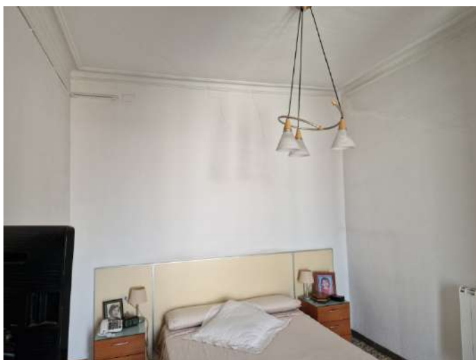
Mitgera i mur de càrrega amb esquerdes 3r 1a
