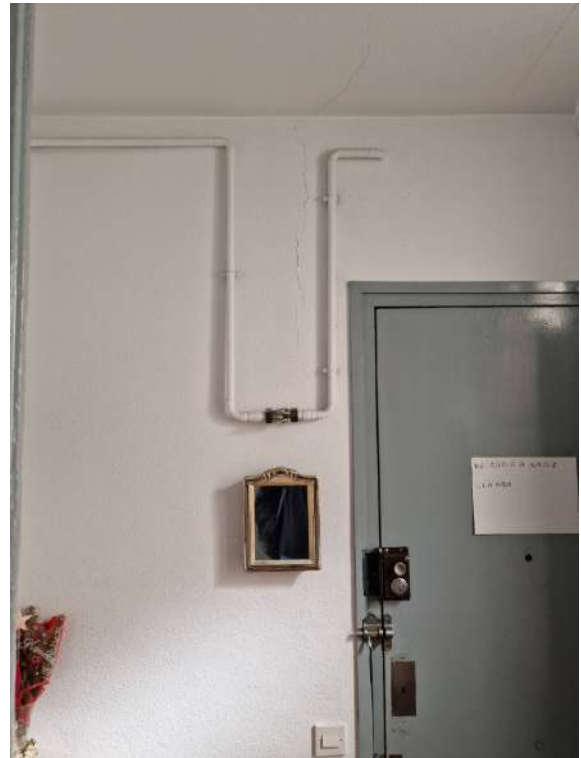
Mur de càrrega 3r amb esquerda per l'interior de l'habitatge.
