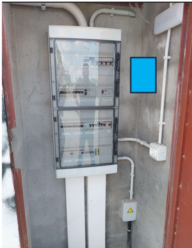
ARMARI CONSUMS - Mesura de Consums ( Quadre Medició – Meter+ Reg. Verificació + Fuse)
