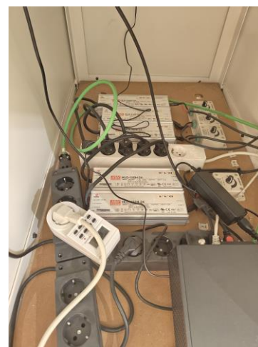
Interior d'un dels armaris locals
