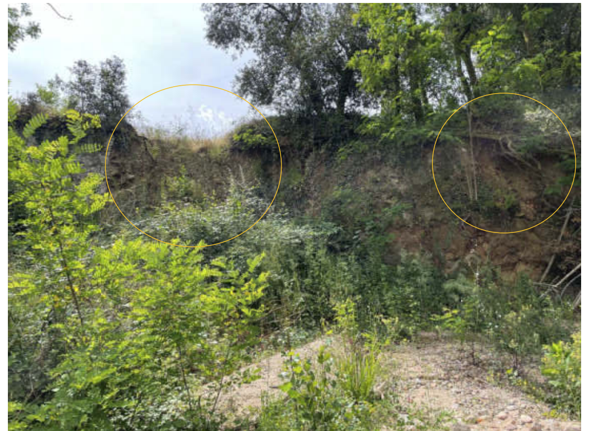
Fig. 3. Inestabilitats de vessant al marge extern del meandre situat a l'alçada de la Casica, per soscavació del peu de l'escarpament de sòls. S'identifiquen varis lliscaments o petits cops de cullera en aquest tram de la riera, corresponent a la riba esquerra, a l'alçada del mur de pedra.
