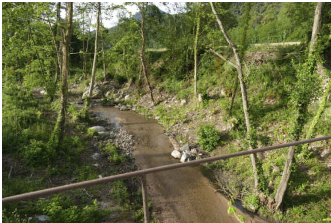
Fig. 38. Vista de la llera de la riera d'Arbúcies des del pont de la Turbina. Observar l'escarpament en sòls de la terrassa T1, on s'aprecia alguna inestabilitat de vessant puntual.
