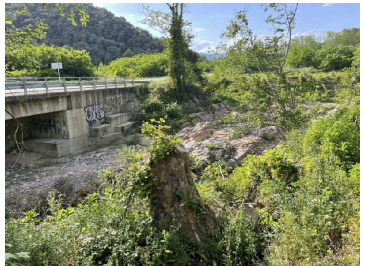
Fig. 52. Pont de la carretera GI-552 sobre la riera d'Arbúcies a l'alçada del prat Marquès. En aquest punt s'observa l'aforament de substrat rocós i l'acumulació de sediments de llit de riu, a banda d'alguna inestabilitat en el sector de vessant comprès entre aquest punt i la pedrera de les Gavarres.
