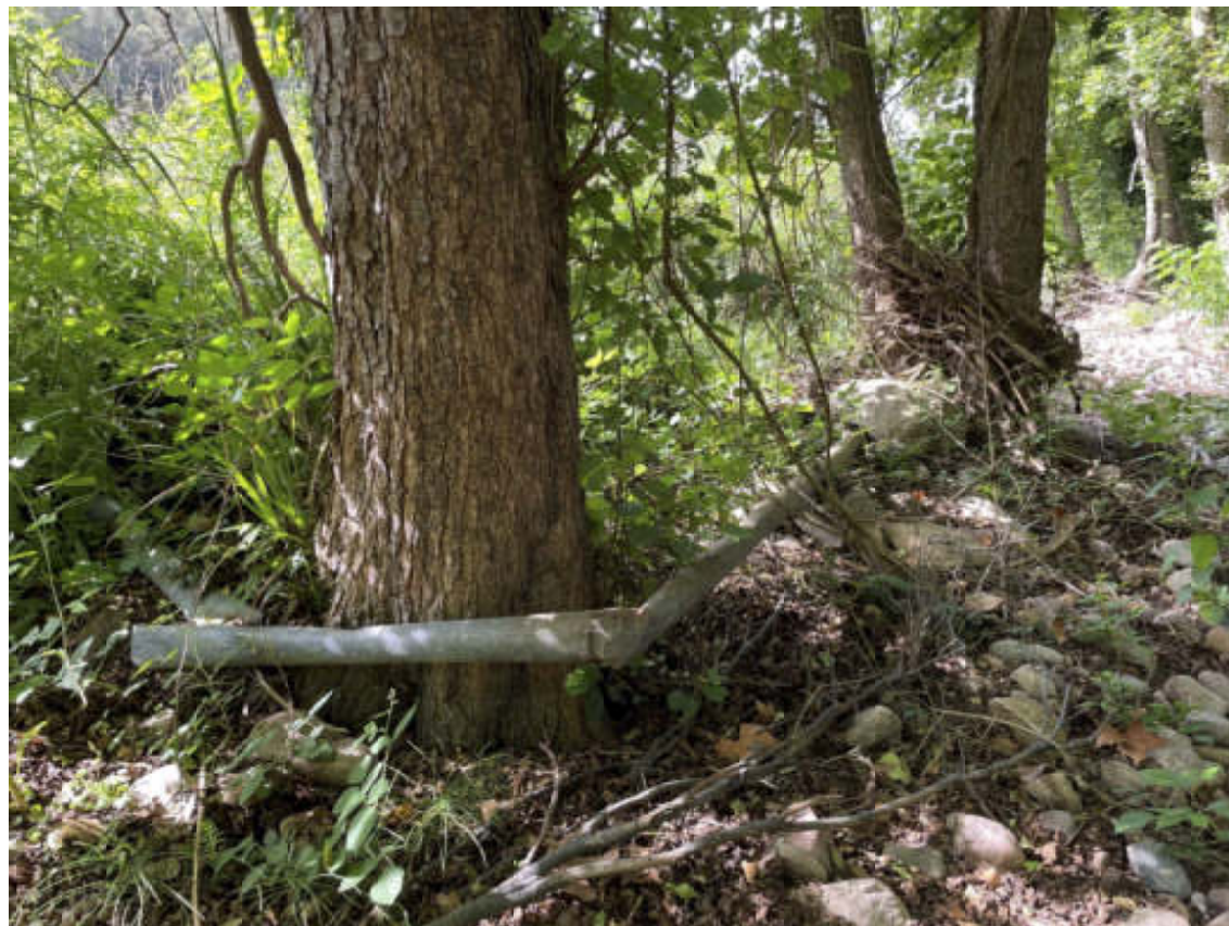
Fig. 13. Trencament d'una canonada per la força de l'aigua, a la mateixa llera de la riera de la Pineda.
