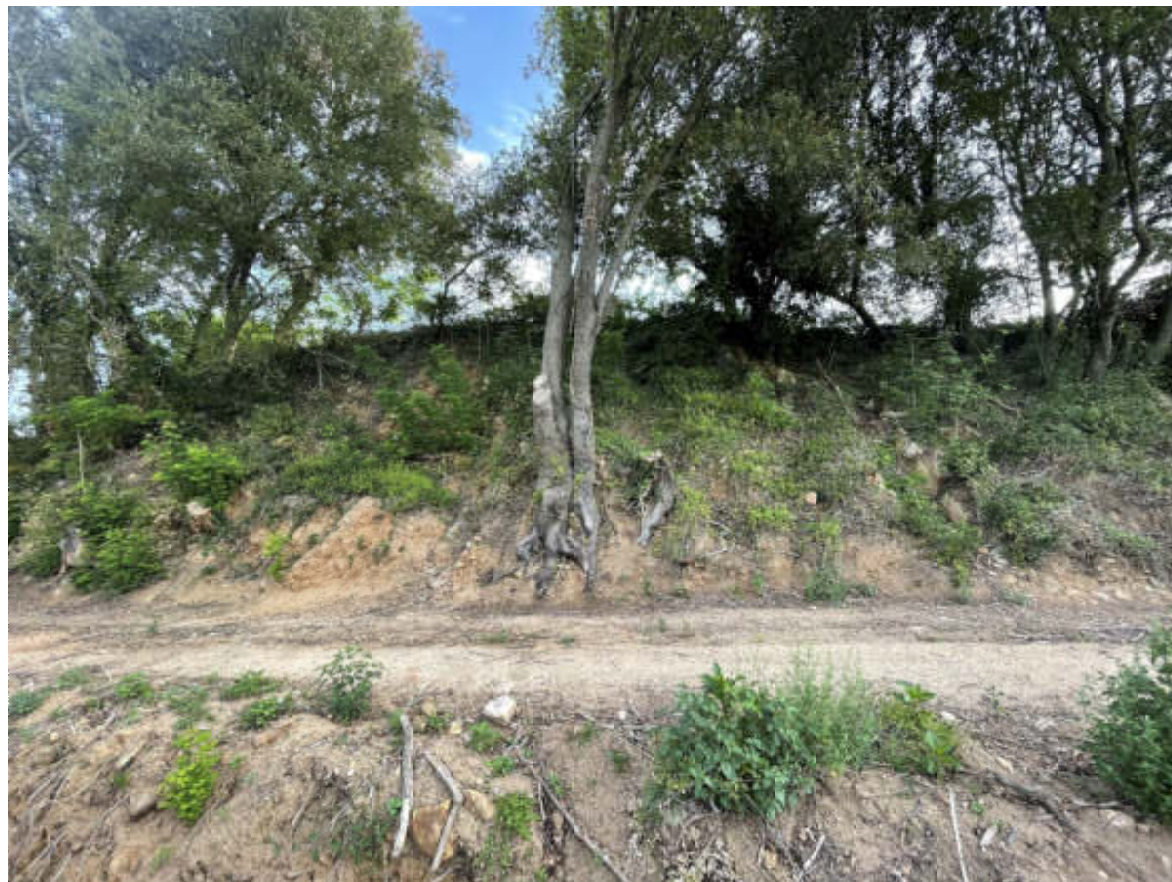
Fig. 42. Exemple d'inestabilitats de vessant en forma de lliscaments rotacionals.
