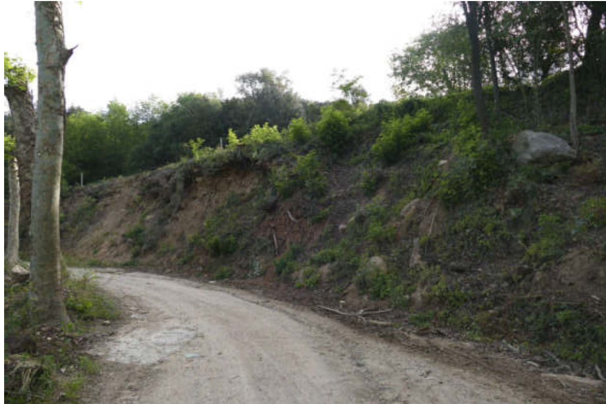
Fig. 41. Escarpament que delimita les feixes de la Teuleria, on s'observa el contacte entre el substrat rocós granític i els dipòsits de terrassa fluvial Qt2. Apreciar les inestabilitats en forma de lliscaments rotacionals al llarg del talús.
