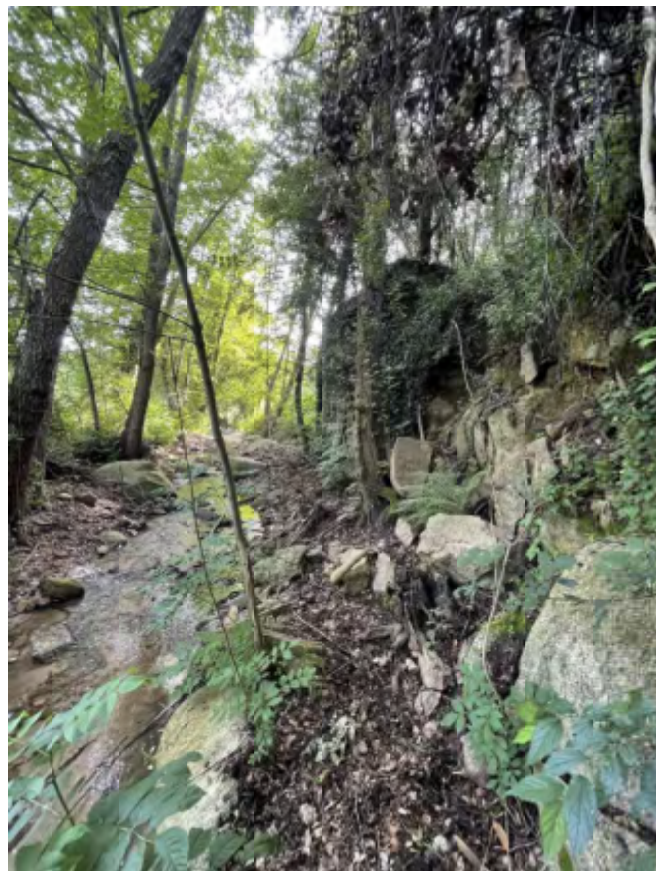
Fig. 18. En algun punt del recorregut, la riera discorre per marges on aflora el substrat rocós granític, sovint diaclasat i amb indicis d'inestabilitat en forma de caiguda de blocs rocosos.
