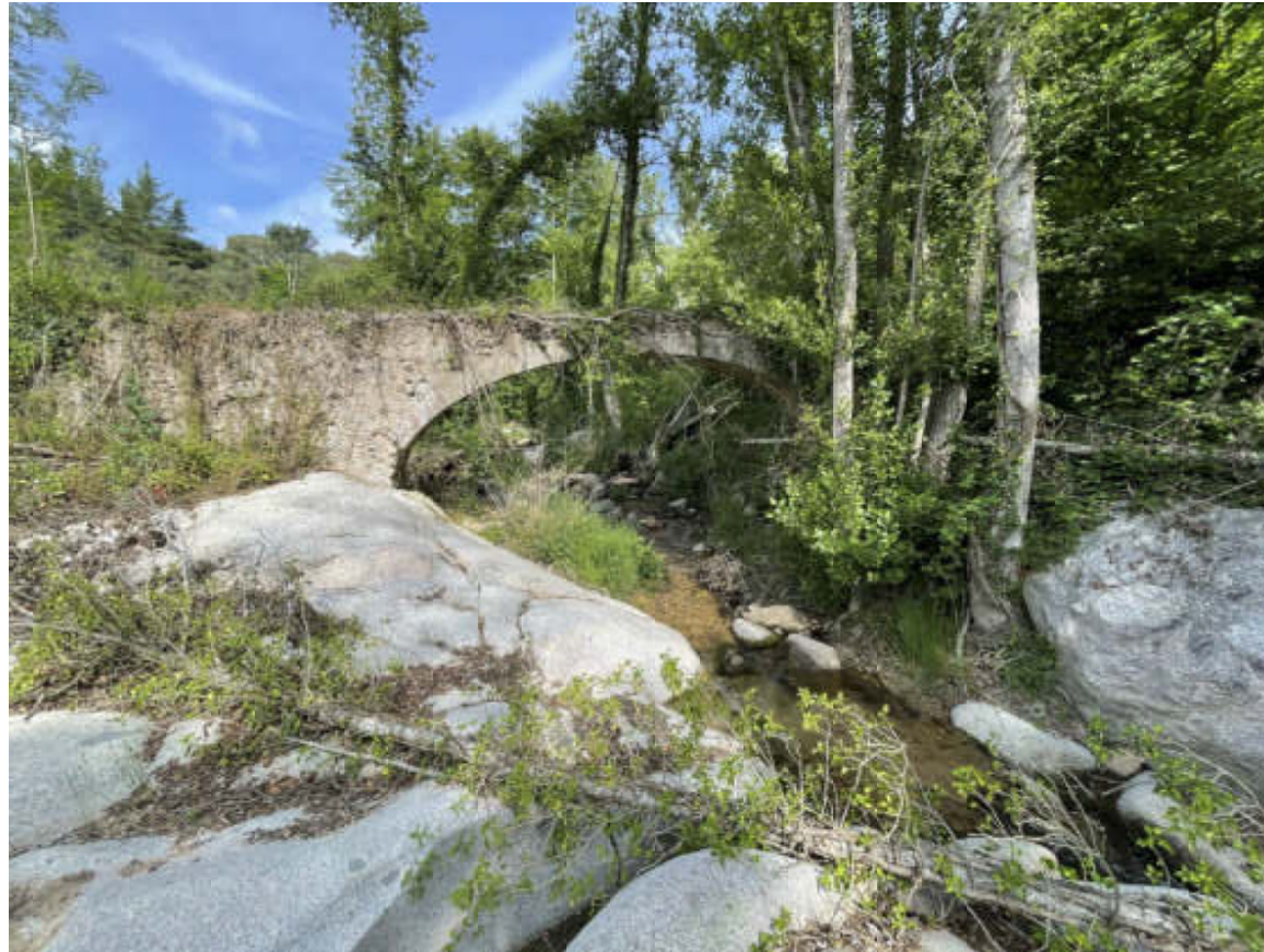
Fig. 21. Aigües avall de can Pujató la riera passa per un llindar rocós granític on es construí, antigament, un pont de pedra, tram a partir del qual s'observa l'acumulació d'una gran barra de sorra mostrada a les següents fotografies..
