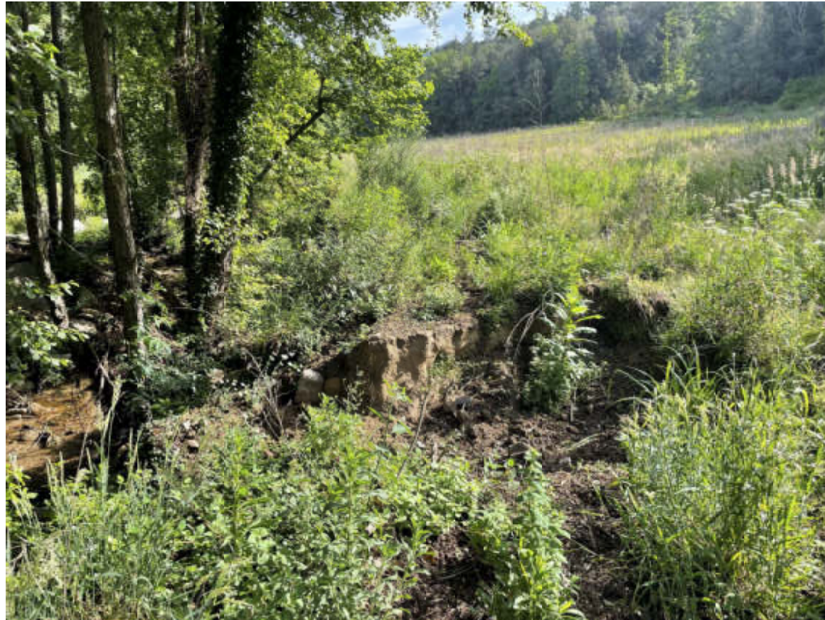
Fig. 17. Exemple de cicatriu d'erosió per socavació lateral de la riba esquerra de la riera de la Pineda, produint un petit escarpament que afecta a un dels camps més meridionals de can Pugetó.
