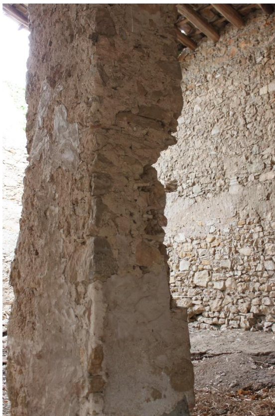
Detall de patologia del pilar de pedra
