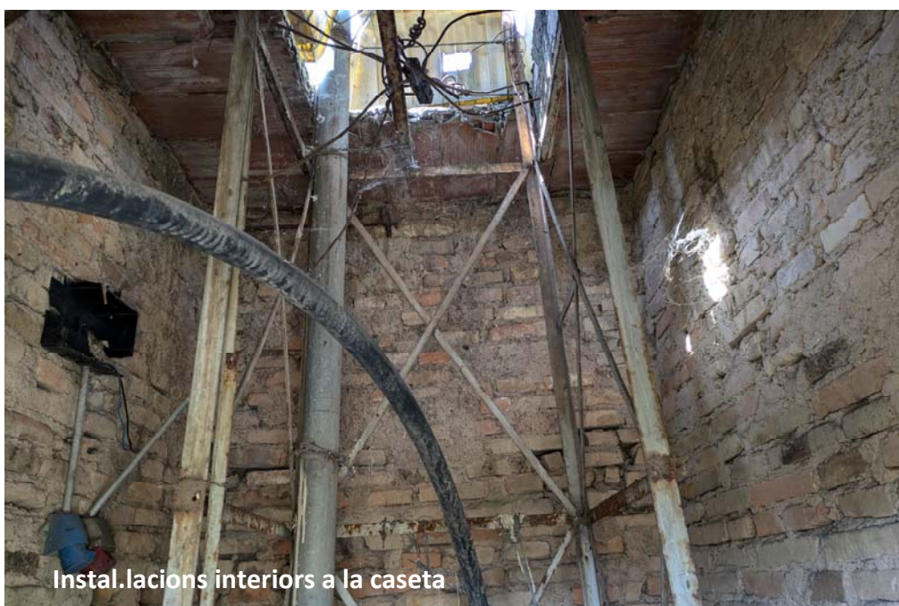
Instal.lacions interiors a la caseta
