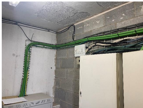
Recorregut del cablejat
