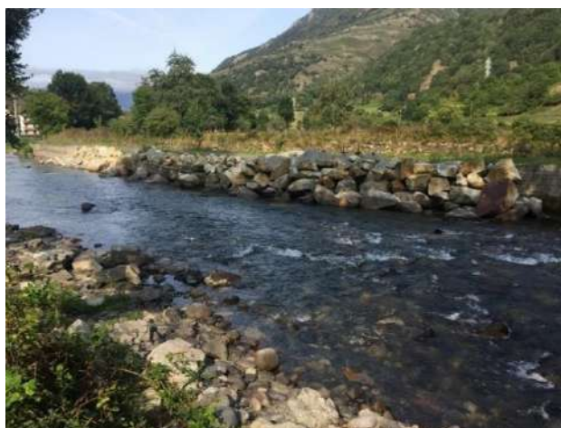
Imatge 9: Tram de mur esfondrat, actualment protegit per escullera abocada
