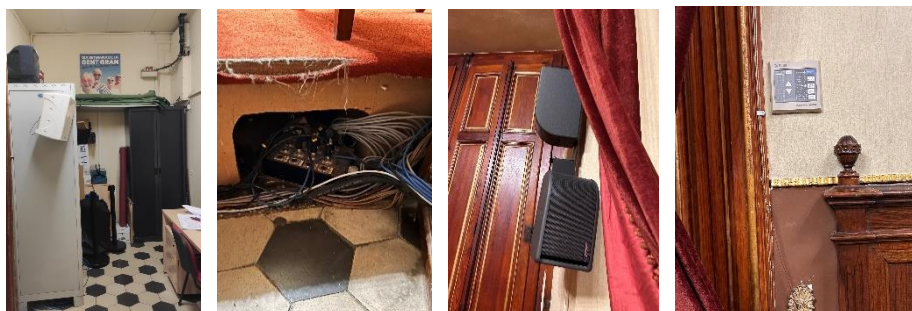
Estat inicial. Fotografies d'instal·lacions de l'estança adjacent i de la sala de Plens. Font: Arquitectura Genís Planelles SLP.
