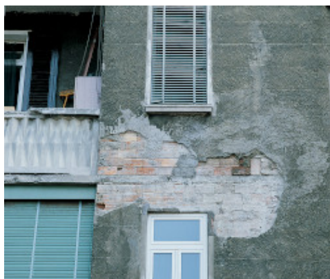
Edificio degradado que precisa de una reparación
