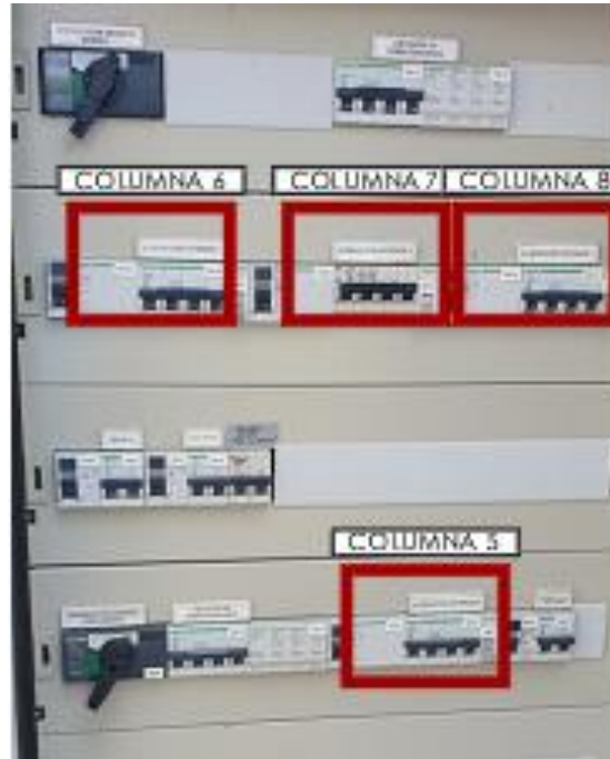
Imatge del quadre existent amb la relació dels circuits de les torres
