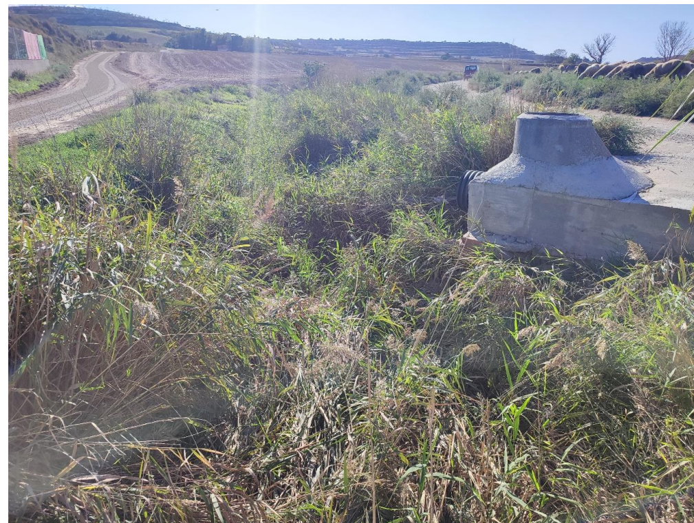
Sota el camí que transcorre paral·lel al riu transcorre un col·lector d'aigües residuals, amb algun sobreeixidor, com el del Pk 7+900
