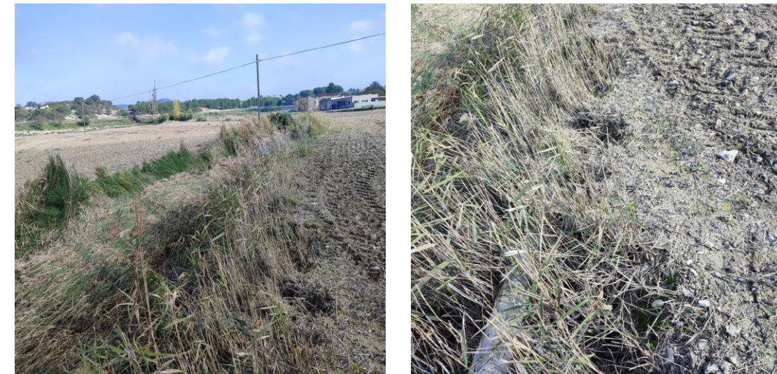
Fig. 13. A l'esquerra, imatge del torrent del Prat poc abans de la seva desembocadura en el riu Ondara. A la dreta, detall del marge erosionat del torrent, amb un pal fusta d'un servei (possiblement d'estesa elèctrica) disposat a la part superior del talús per protegir-lo de la fort erosió
