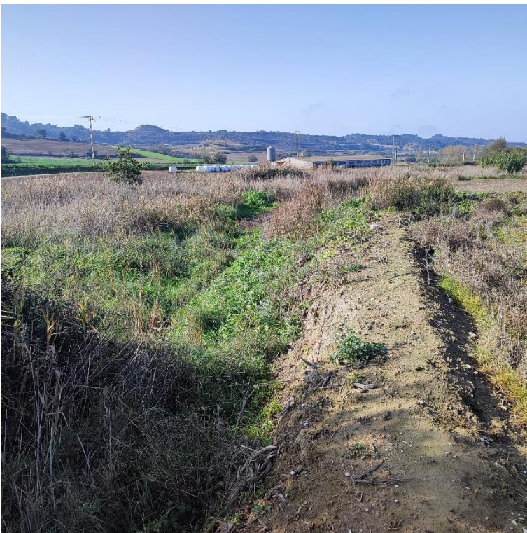
Marge esquerre (1+200). Just davant de la zona d'abocament. S'observa un cavalló de terres pressionant cap al riu. A sota, hi ha vegetació ruderal abans d'arribar a la llera.
