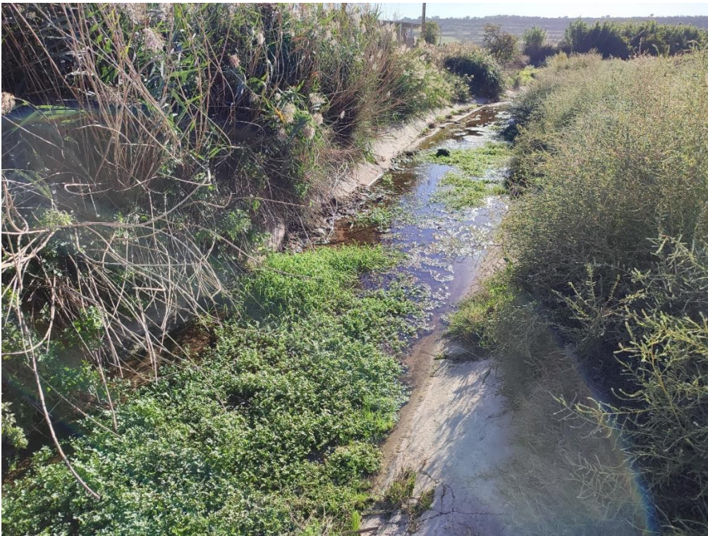
Entre els Pks 8+500 i 8+650 el tram del riu està artificialitzat amb una secció definida i coberta amb una capa de formigó. A partir d'aquest tram, s'observa aigua corrent.
