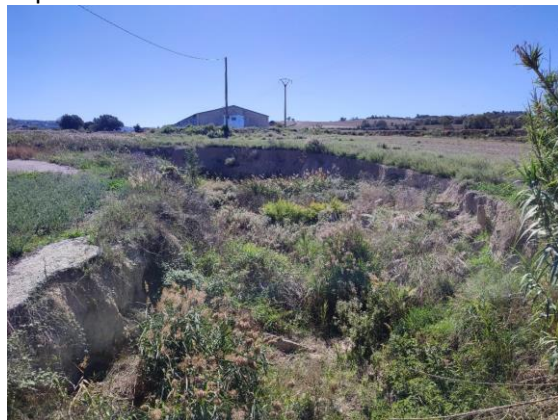
Fig 23. Gran punt d'erosió derivat d'una riuada, al Pk 1+600
