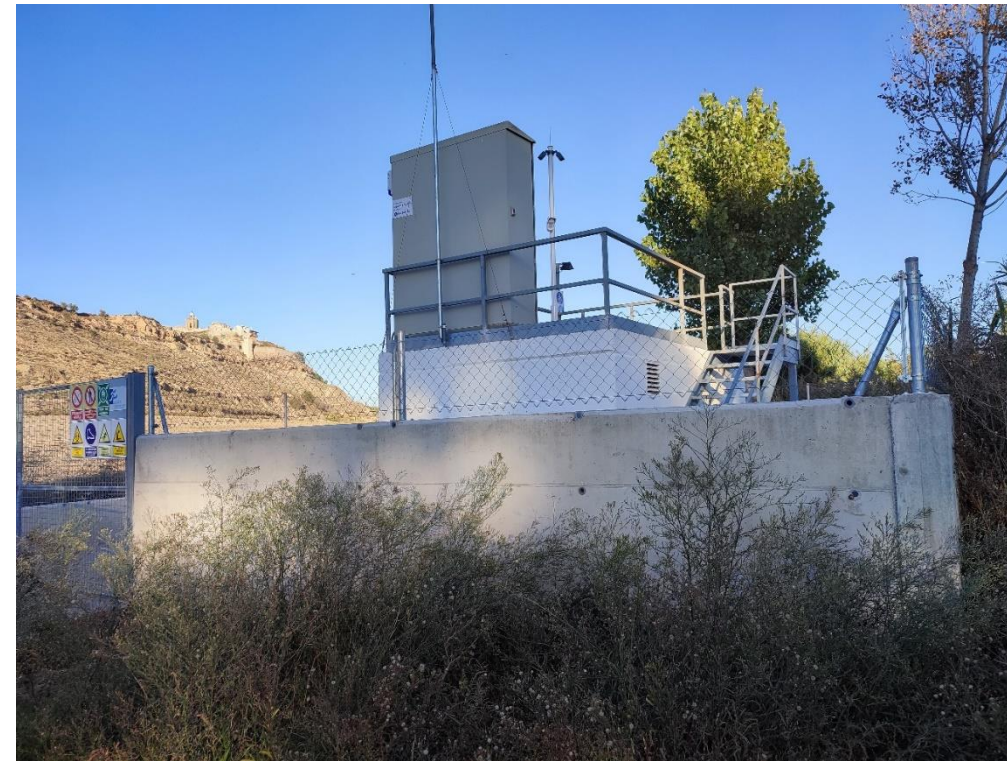
Estació de bombament amb sobreexidor a l'alçada del Molí d'en Grau. Aquesta estació presenta problemes i en determinades ocasions aboca tota l'aigua residual al riu
