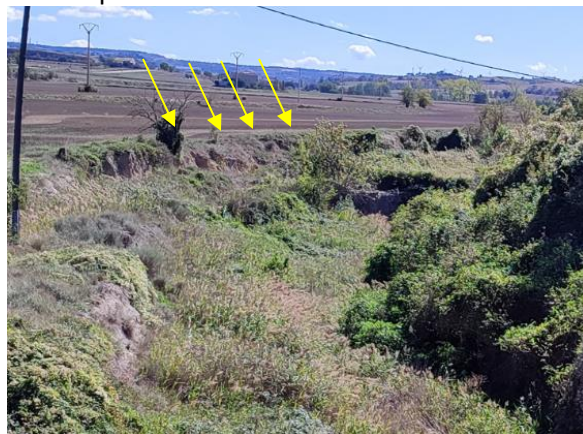
Fig 24. Erosió al marge esquerre just abans del pont de Sant Pere dels Arquells
