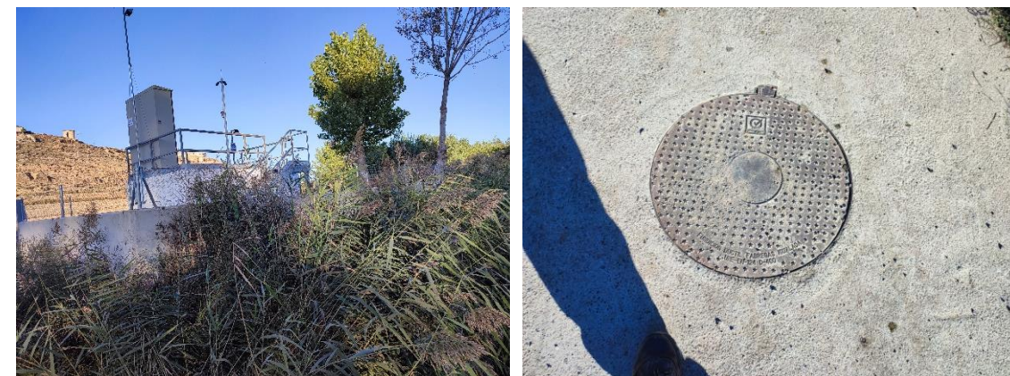
Fig 2. Estació de bombament a l'alçada del Moli de Sant Pere Gros; a la dreta, registre del col·lector
