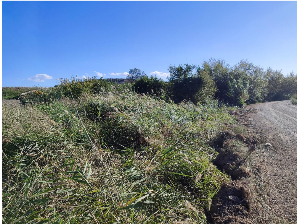
Al tram 6 (Pk 8+400) continua la pressió derivada de la presencia del camí i els terrenys agrícoles. S'observa com les millores en el camí impliquen moviments de terres cap al riu. Per altre banda, el riu té una gran proliferació de canyís
