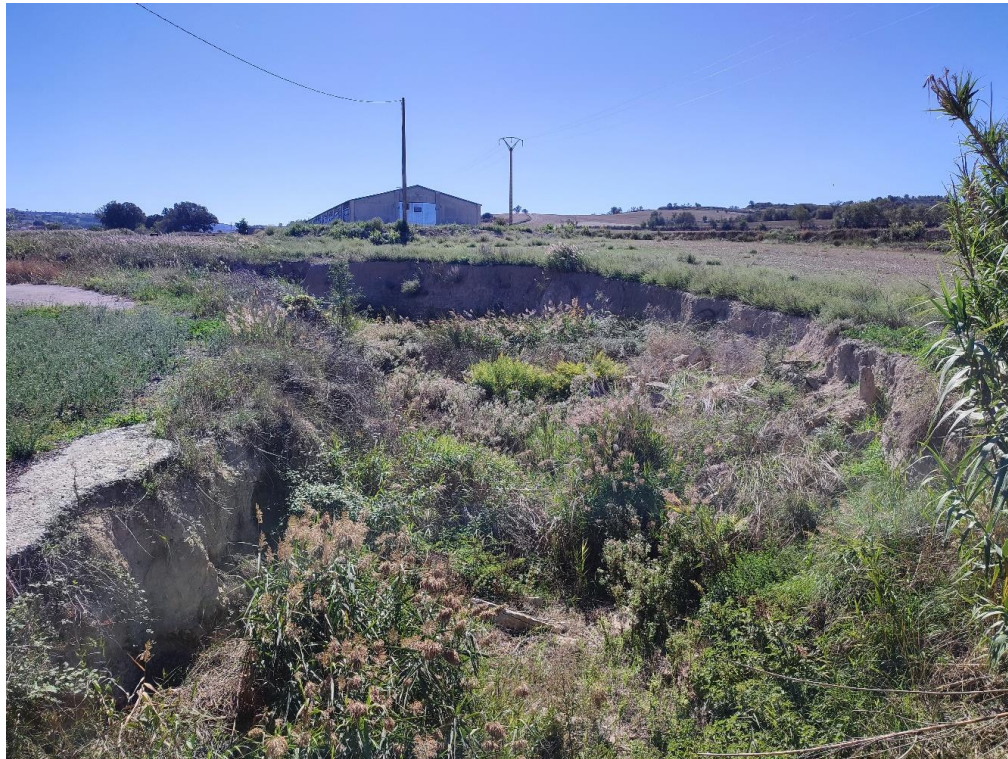
Tram fortament erosionat pel riu (Pk 1+500)
