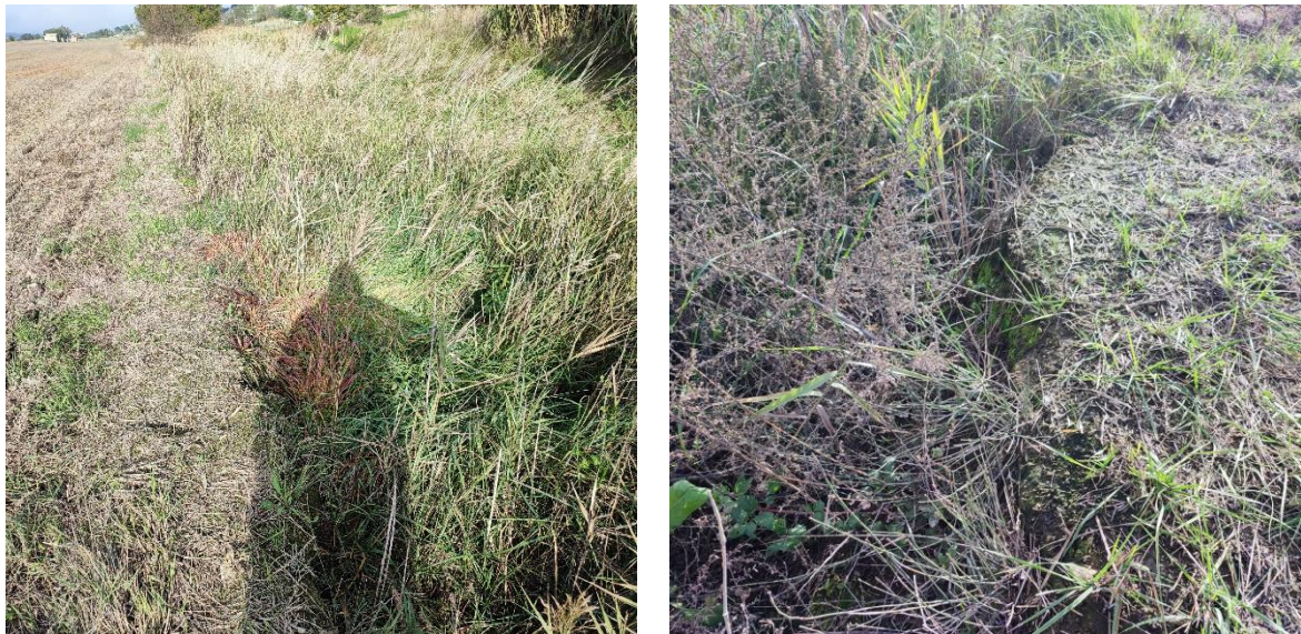
Ocupació dels conreus cap la llera, i erosió. Vista general i detall. Entre pont LV-3031 i pont L-203 (0+475)
