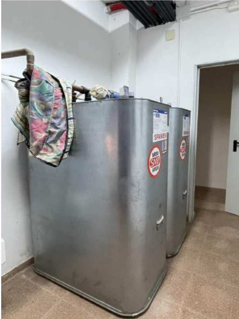
Imatge 14 : Sala d'instal·lacions situada a la planta baixa.
