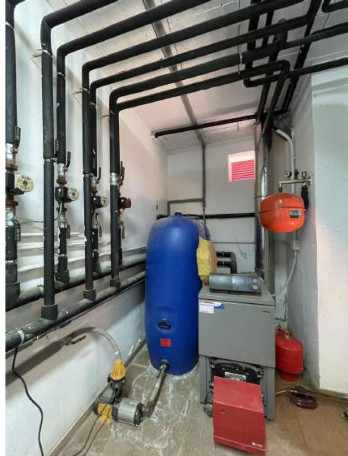
Imatge 13 : Sala d'instal·lacions situada a la planta baixa.
