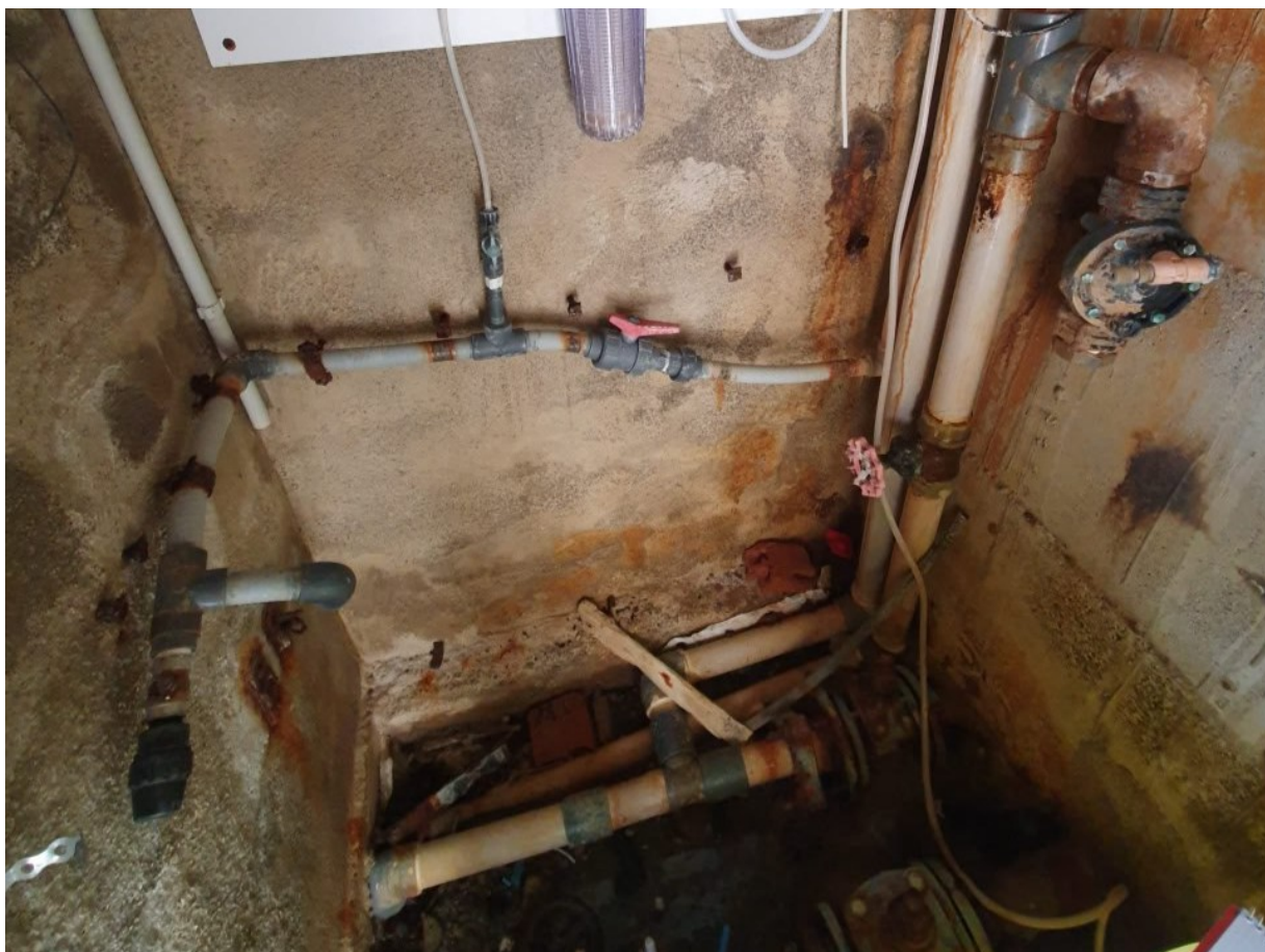
Xarxa Ainet de Cardós - caseta dipòsit
