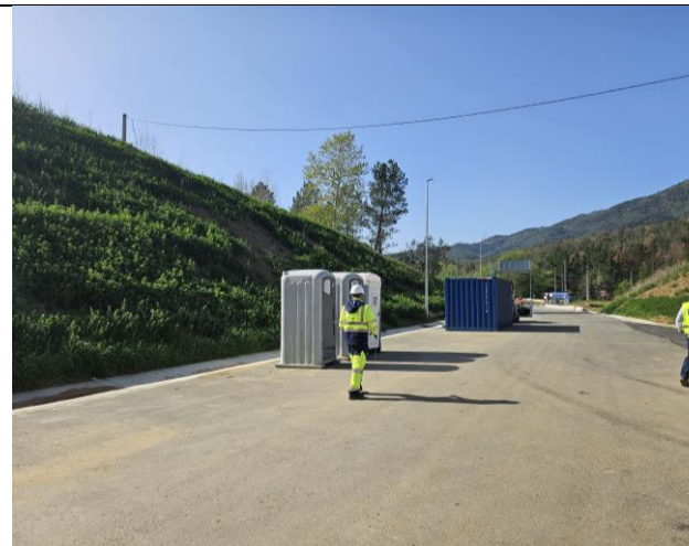
Talussos en desmunt de més de 3 m a la boca sud del túnel. Presenten un recobrint herbaci desigual després de les hidrosembres aplicades en el marc del projecte.
