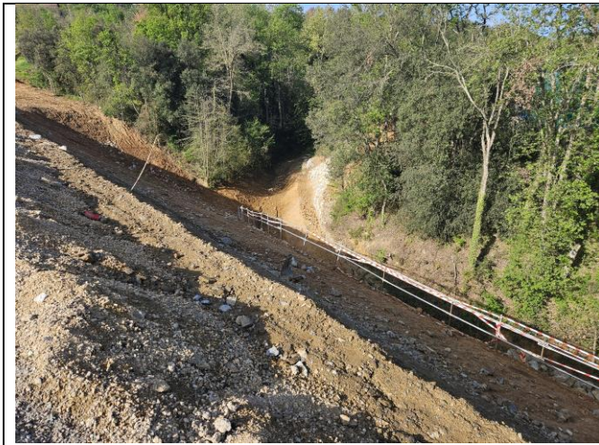
Talussos en terraplè de més de 3 m i canalització del rec de Ca n'Aulet
