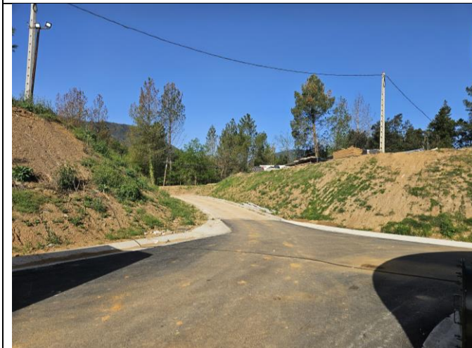
Talussos en desmunt de menys de 3 m a tocar de la rotonda d'enllaç amb la C-63. Revegetats parcialment després de les hidrosembres aplicades en el context de les obres del projecte.
