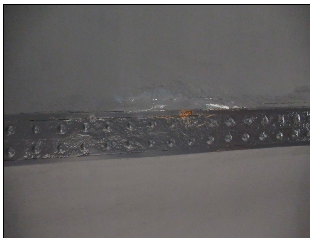
Foto 16: Oxidacions perfils metàl·lics.
