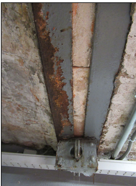
Foto 9: Detall oxidacions bigues IPE.
