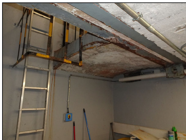
Foto 6: Oxidacions bigues IPE nivell inferior.
