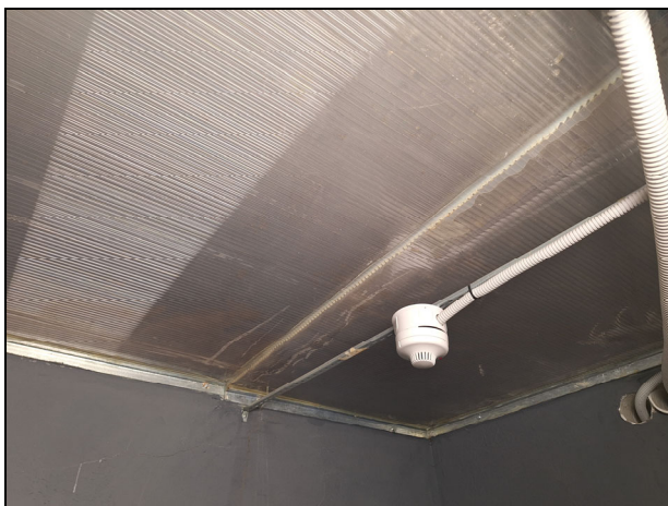
Foto 25: Filtracions sala control.
