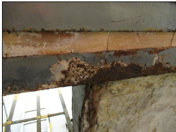
Foto 8: Detall oxidacions bigues IPE.
