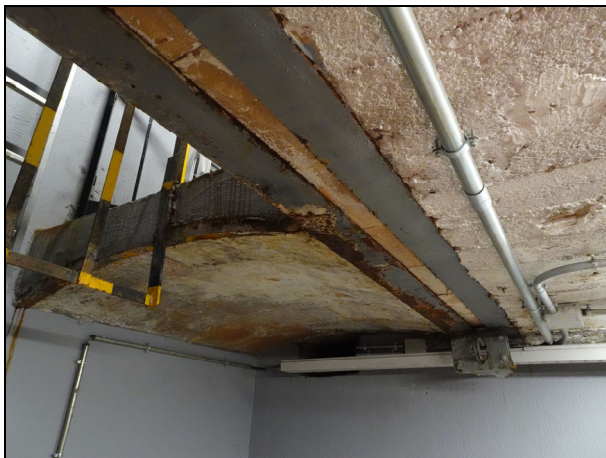
Foto 7: Oxidacions bigues IPE nivell inferior.
