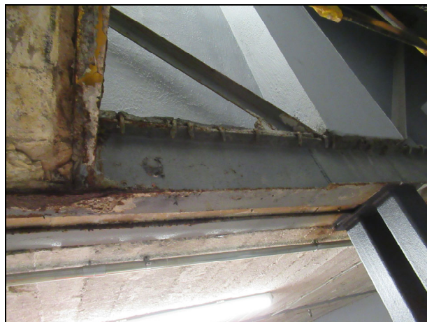
Foto 12: Detall oxidacions bigues IPE.
