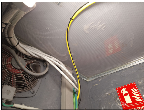
Foto 28: Filtracions sala baixa tensió.
