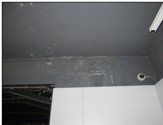
Foto 14: Humitats junta estació – túnel.
