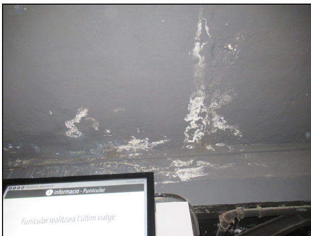
Foto 13: Humitats junta estació – túnel.
