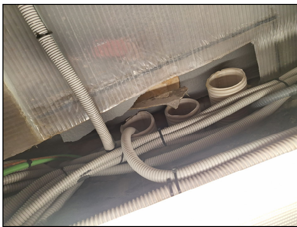
Foto 30: Despreniments sala baixa tensió.
