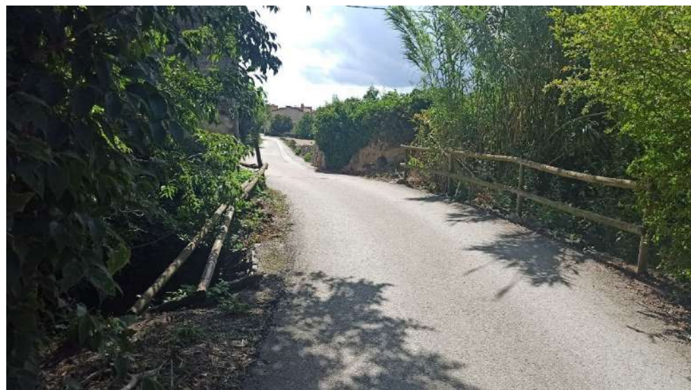
Fotografia 1. Tram compartit i barana de fusta malmesa a l'alçada del Gustet
