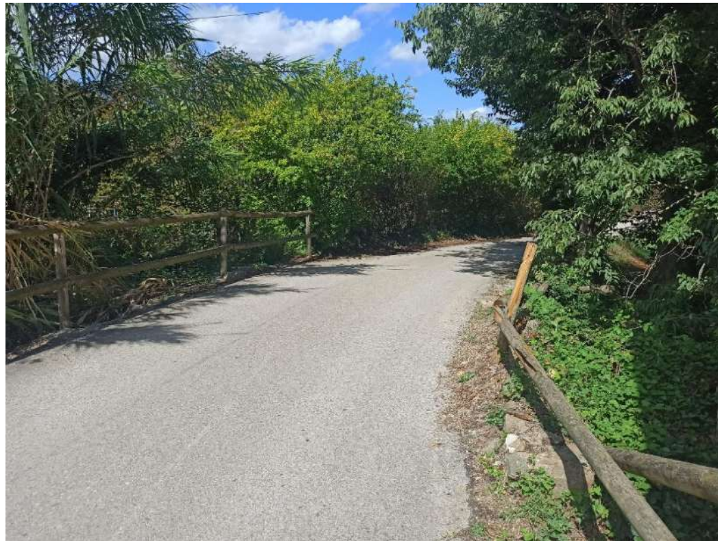
Imatge núm. 4. Detall de barana malmesa al carrer del Riu Brugent
