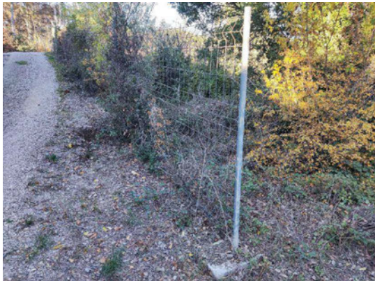
Figura 9. Tancament de protecció deteriorat (inici)
