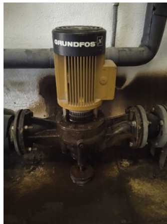
Bomba Impulsora Principal Grundfos
