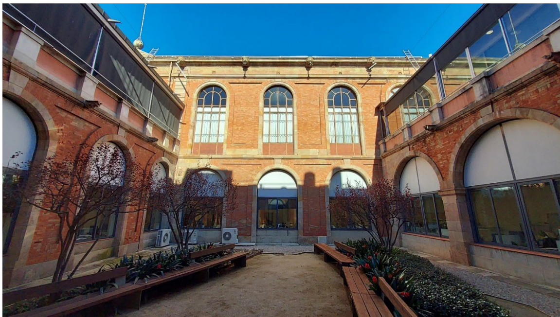
Ventanales a substituir del patio posterior sur (FS-1, FS-2 y FS-3)
