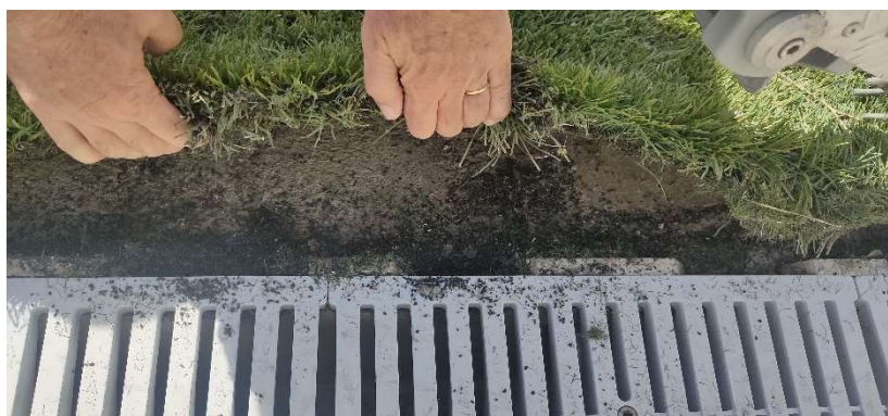
Detalls de l'estat de la gespa i de la base d'asfalt
