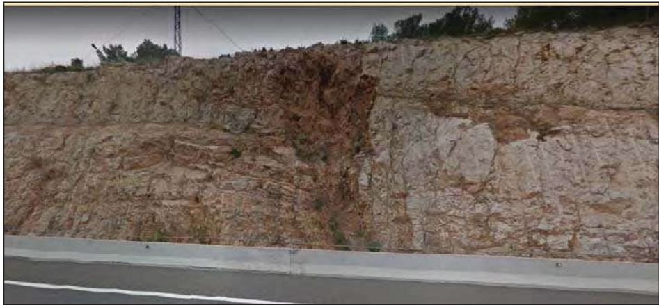
Fig. 9.-Vista dels talussos del substrat rocós de calcàries del Cretaci a la part dels talussos de la A-7, on s'observen les discontinuïtats reomplertes per argiles.
